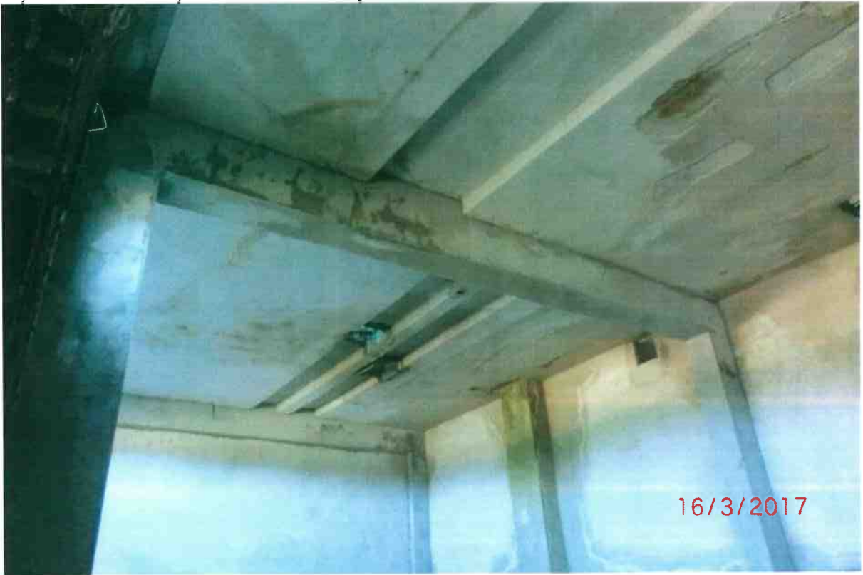
Rys. nr 7 - Stan budynku ZEW-67 wewnątrz.
