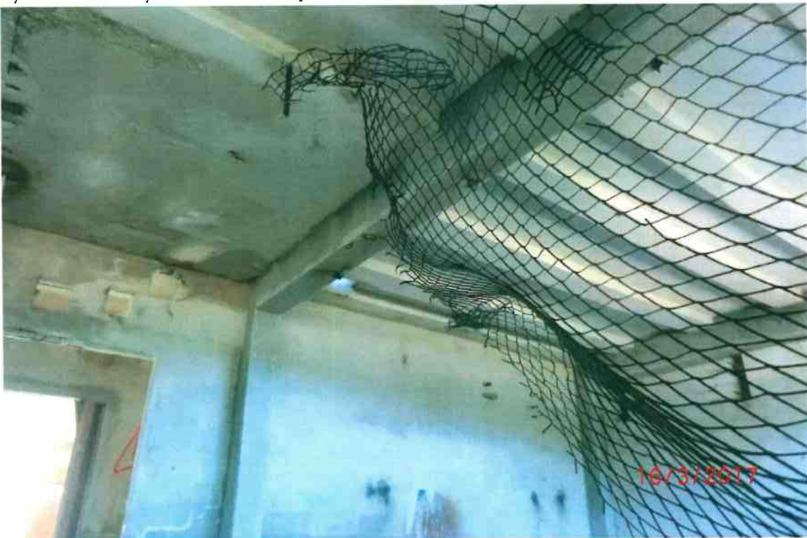
Rys. nr 6 - Stan budynku ZEW-67 wewnątrz.
