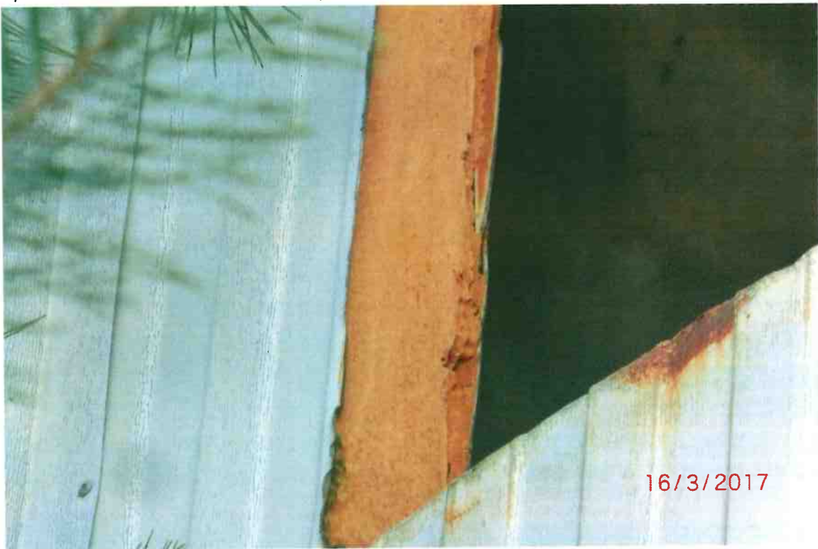
Rys. nr 4 - Zniszczona ściana - otwór w miejscu okna
