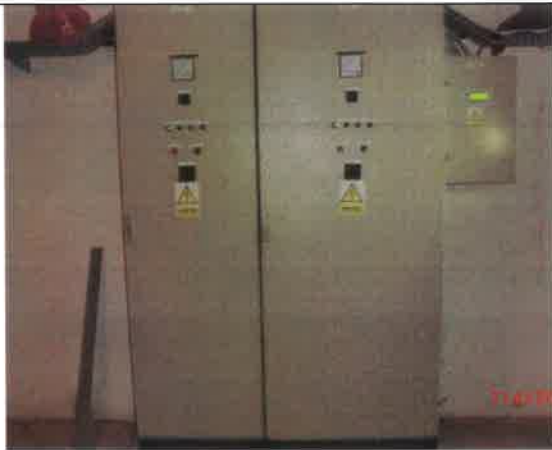
Fot. – 61 (Poziom -2.50) – pomieszczenie wentylatorowni i AKPiA – szafa sterownicza pomp – do rozbudowy.
