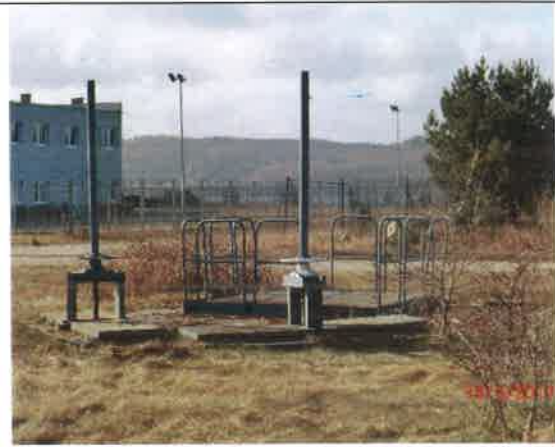
Fot. 16 – pokrywy luków montażowych i trzpienie zasuw - do oczyszczenia i zabezpieczenia antykorozyjnego. Naprawa i uruchomienie zasuw.
