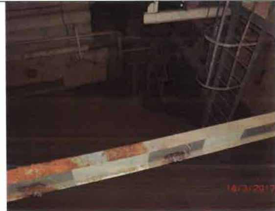
Fot. – 76 (Poziom -2.50) – Galeria – istn. drabina ewakuacyjna z poziomu -6.10 – do wyczyszczenia, zabezpieczenia antykorozyjnego i pomalowania.
