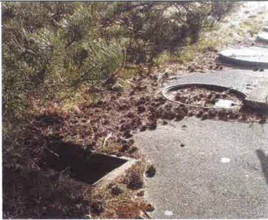
Fot. 13 – pokrywy włazów i rewizji – do wymiany i uzupełnienia.
