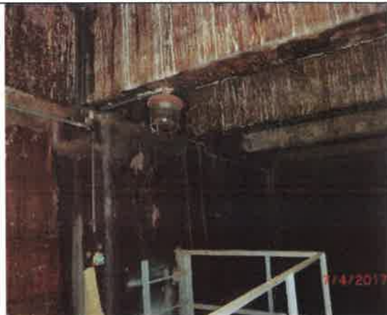
Fot. – 86 (Zbiorniki wody deszczowej) – istniejące oświetlenie do wymiany i uzupełnienia oświetleniem ledowym (ok. 10 szt. oprav).
