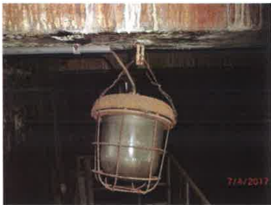
Fot. – 85 (Zbiorniki wody deszczowej) – istniejące oświetlenie do wymiany i uzupełnienia oświetleniem ledowym (ok. 10 szt. oprav).
