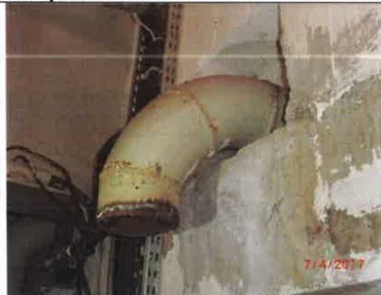
Fot. – 71 (Poziom -2.50) – Korytarz prowadzący do zbiorników – istn. rurociągi do demontażu; otwory do zamurowania.
