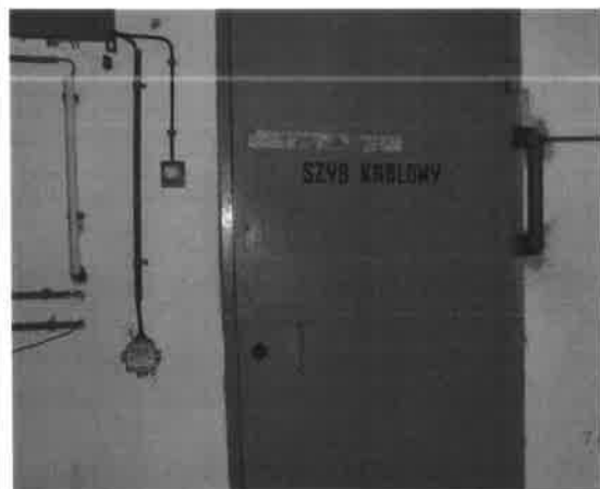
Fot. – 59 (Poziom -2.50) – szyb kablowy – zamek w drzwiach do uzupełnienia + klucze.
