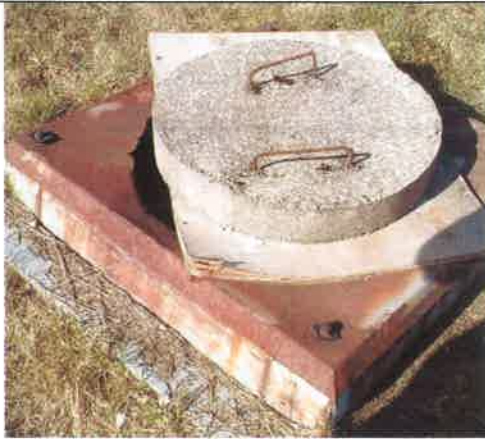
Fot. 25 – Wywietrzak zbiornika – do odtworzenia.
