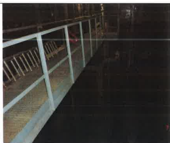
Fot. – 83 (Zbiorniki wody deszczowej) – pomost do oczyszczenia, zabezpieczenia antykorozyjnego i pomalowania.
