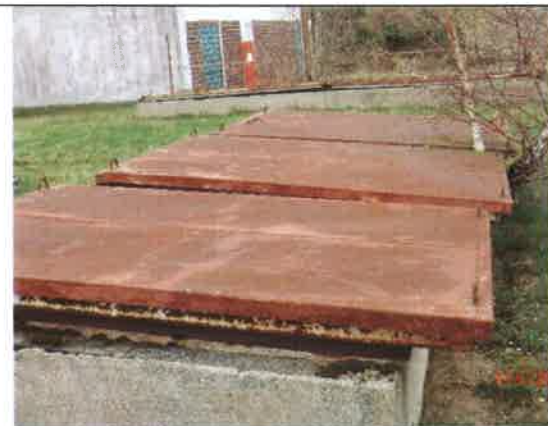
Fot. 27 – pokrywy łuków montażowych – częściowo do oczyszczenia i zabezpieczenia antykorozyjnego, częściowo do wymiany.
