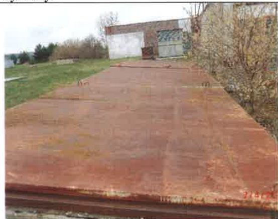
Fot. 28 – pokrywy łuków montażowych – częściowo do oczyszczenia i zabezpieczenia antykorozyjnego, częściowo do wymiany.
