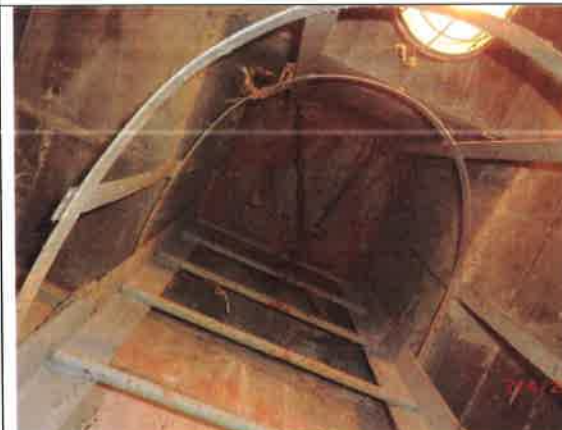
Fot. – 78 (Poziom -2.50) – Galeria – istn. drabina ewakuacyjna – do wyczyszczenia, zabezpieczenia antykorozyjnego i pomalowania.
