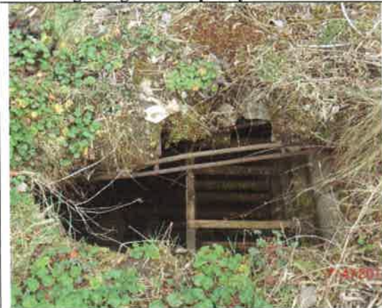
Fot. 10 (Teren) – przykrycie kanału technologicznego – do naprawy.
