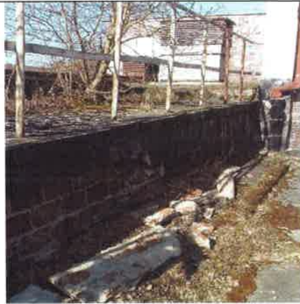
Fot. 32 – Murek oporowy – do naprawy.
