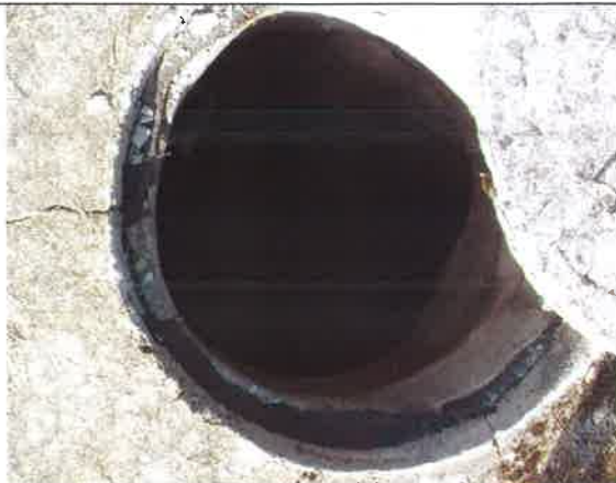
Fot. 19 – Obudowa wjazdu do naprawy. Pokrywa – do wymiany.
