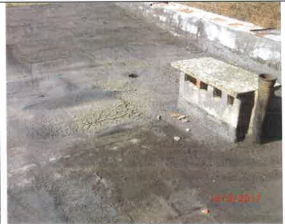
Fot. 40 – Pokrycie dachu do wymiany. Komin i wywiewka kanalizacyjna do naprawy.
