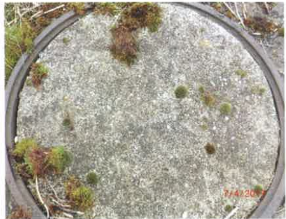
Fot. 20 – Pokrywa wjazdu – do wymiany.
