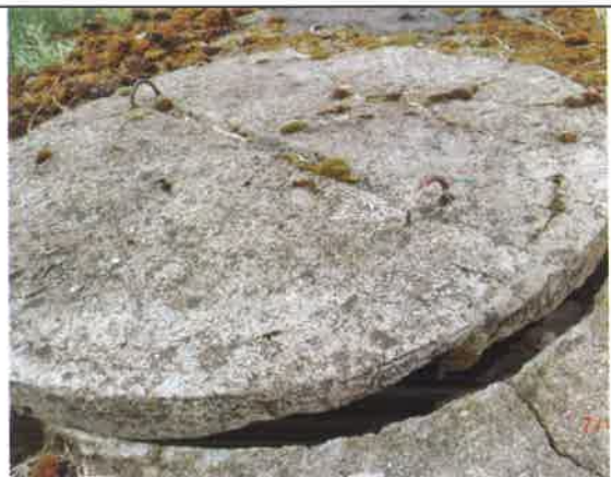
Fot. 21 – Obudowa wjazdu do naprawy. Pokrywa – do wymiany.
