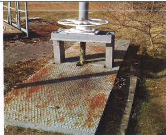
Fot. 17 – pokrywy luków montażowych i trzpienie zasuw - do oczyszczenia i zabezpieczenia antykorozyjnego. Naprawa i uruchomienie zasuw.
