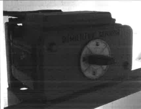
Fot. – 52 (Poziom +1.10) – rozdzielnica oświetlenia klatki schodowej – do konserwacji.
