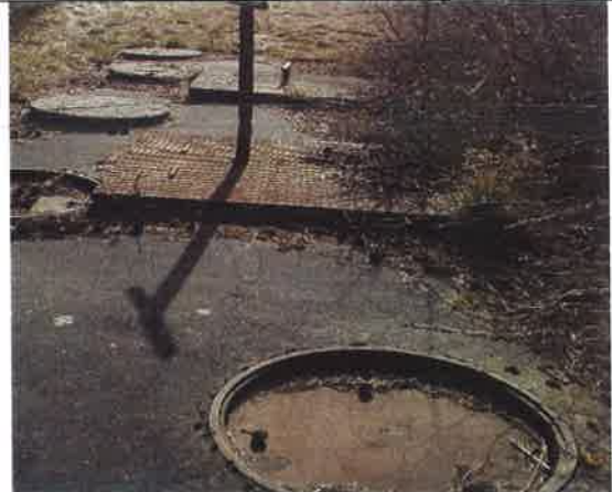
Fot. 14 – pokrywy luków montażowych i trzpienie zasuw - do oczyszczenia i zabezpieczenia antykorozyjnego. Pokrywy włazów – do wymiany. Naprawa i uruchomienie zasuw.
