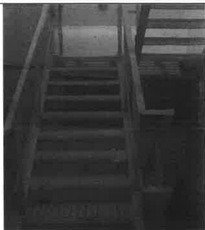
Fot. – 55 (Poziom +1.10) – klatka schodowa. Do uzupełnienia oświetlenie. Schody do oczyszczenia i pomalowania.
