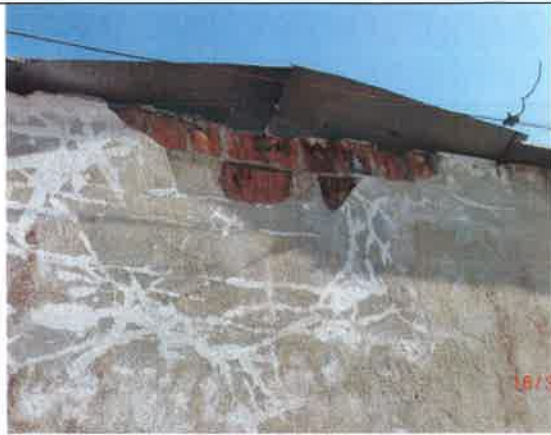
Fot. 31 – Ściana zewnętrzna budynku Polenergia SA – do otynkowania (w uzgodnieniu z właścicielem).
