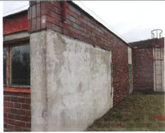
Fot. 34 – Elewacja do uzupełnienia i zabezpieczenia. Drabina włazowa na dach do odczyszczenia i zabezpieczenia antykorozyjnego.
