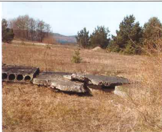
Fot. 9 (Teren) – przykrycie kanału technologicznego – do naprawy.
