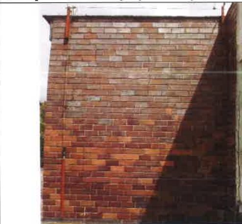
Fot. 41 – Elewacja zewnętrzna z klinkieru – do odspojenia i otynkowania.
