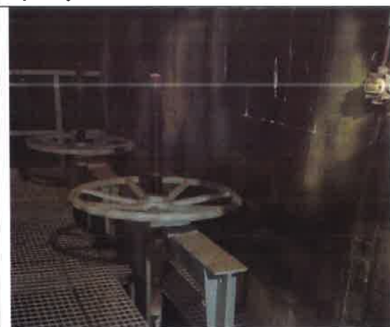
Fot. – 89 (Zbiorniki wody deszczowej) – zasuw przelewowe do konserwacji.
