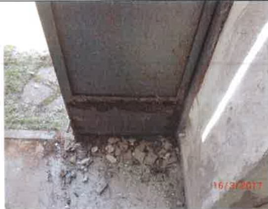
Fot. – 44 (Poziom +1.10) – drzwi zewnętrzne do wymiany.
