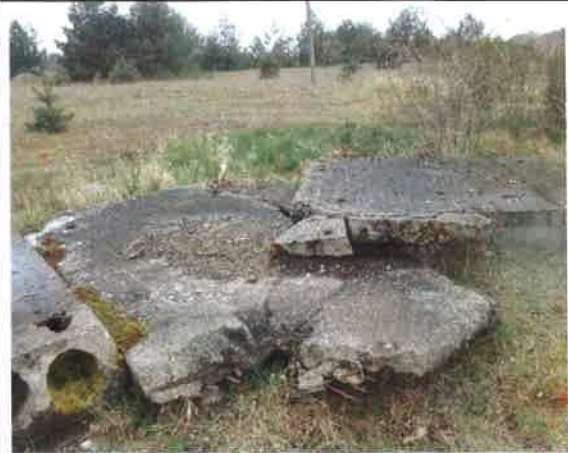
Fot. 8 (Teren) – przykrycie kanału technologicznego – do naprawy.
