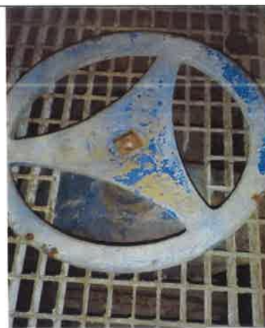
Fot. – 90 (Zbiorniki wody deszczowej) – zasawa odcinająca na rurociągu tłocznym ścieków deszczowych – do konserwacji.
