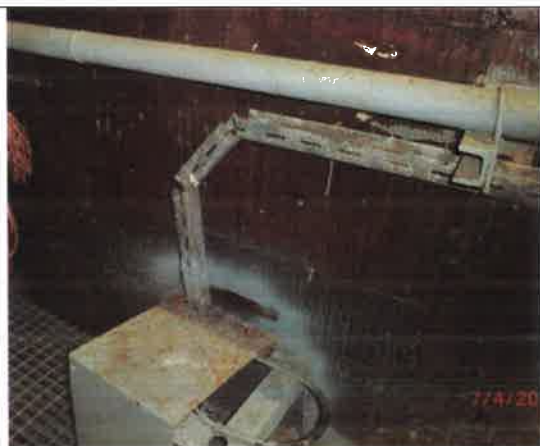
Fot. – 87 (Zbiorniki wody deszczowej) – istn. rurociągi wody i skrzynki do demontażu i utylizacji.
