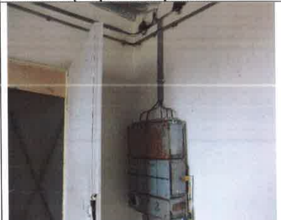
Fot. – 48 (Poziom +1.10) – rozdzielnica do przebudowy, usunięcie zbędnych instalacji, malowanie ścian, naprawa i uzupełnienie oświetlenia, dorobienie zamka lub kłódki do drzwi.
