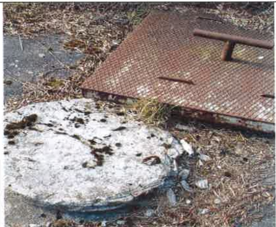
Fot. 15 – pokrywy luków montażowych i trzpienie zasuw - do oczyszczenia i zabezpieczenia antykorozyjnego. Pokrywy włazów – do wymiany. Naprawa i uruchomienie zasuw.
