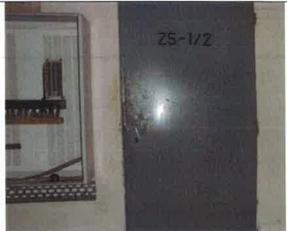
Fot. – 68 (Poziom -2.50) – komunikacja. Wejście do wyłączonych z użytkowania zbiorników ścieków sanitarnych – do zabezpieczenia i oznakowania.
