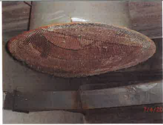
Fot. – 74 (Poziom -2.50) – Galeria – istn. osłona wywietrzaka do wymiany. Wywietrzak do zabezpieczenia antykorozyjnego lub do wymiany.
