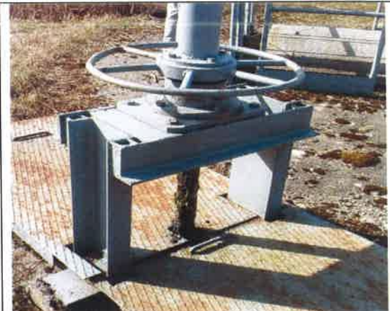
Fot. 18 – pokrywy luków montażowych i trzpienie zasuw - do oczyszczenia i zabezpieczenia antykorozyjnego. Naprawa i uruchomienie zasuw.
