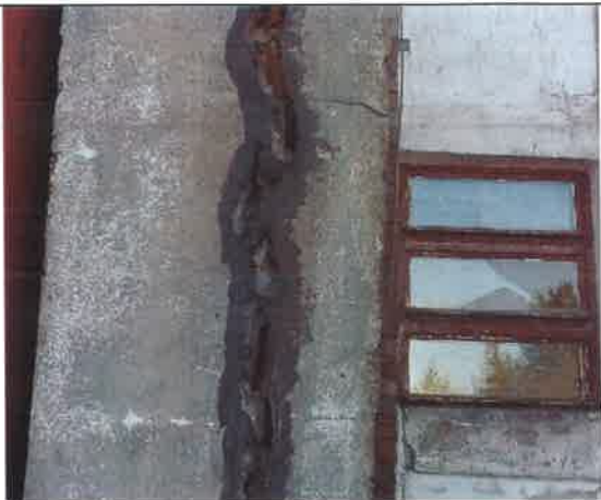
Fot. 37 – Elewacja z klinkieru do odspojenia i otynkowania.
