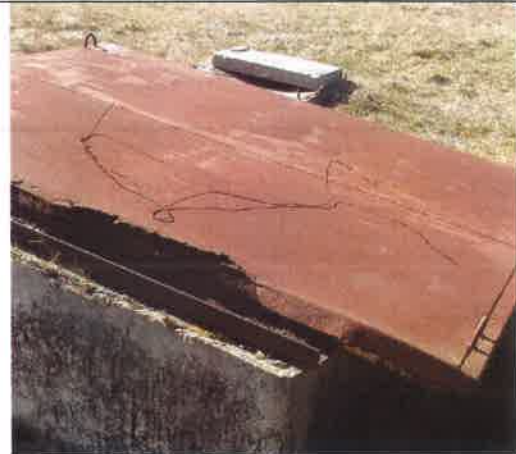
Fot. 26 – pokrywa łuku montażowego – do wymiany.
