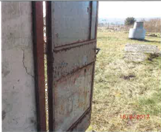
Fot. – 43 (Poziom +1.10) – drzwi zewnętrzne do wymiany.
