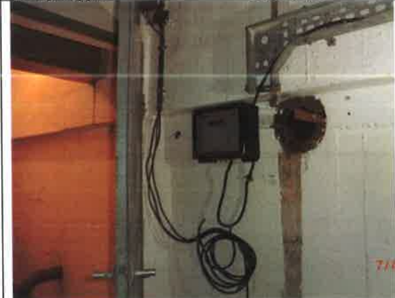
Fot. – 66 (Poziom -2.50) – komunikacja. Nieczynna instalacja sterowania wentylacją.
