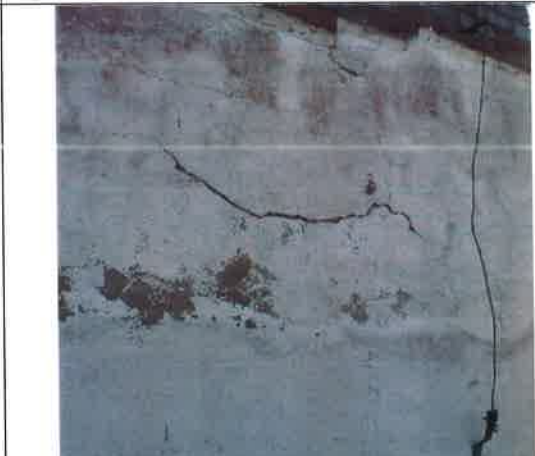
Fot. 42 – Elewacja do naprawy i otynkowania. Instalacja odgromowa do wymiany.
