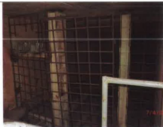
Fot. – 77 (Poziom -2.50) – Galeria – istn. krata zabezpieczająca wyjście z tunelu technologicznego – do odtworzenia i zamknięcia.
