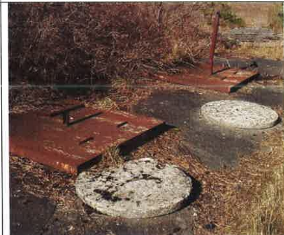
Fot. 12 – pokrywy luków montażowych i trzpienie zasuw - do oczyszczenia i zabezpieczenia antykorozyjnego. Pokrywy włazów – do wymiany. Naprawa i uruchomienie zasuw.
