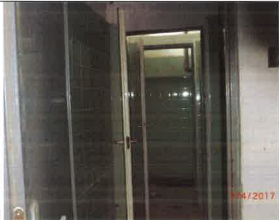
Fot. – 69 (Poziom -2.50) – komunikacja. Nieużytkowane pom. sanitarne – do zabezpieczenia i oznakowania.
