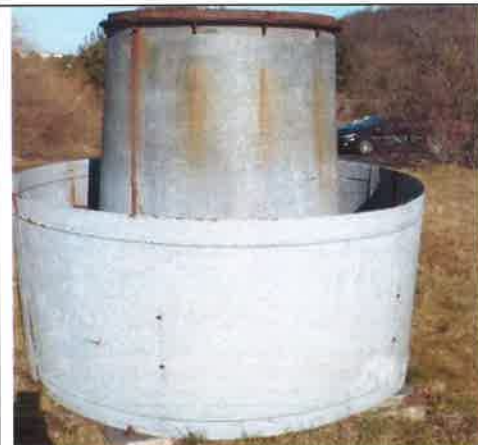
Fot. 22 – Wywiewczak zbiornika – do wymiany (razem 13 szt. wywiewczaków do wymiany i uzupełnienia)
