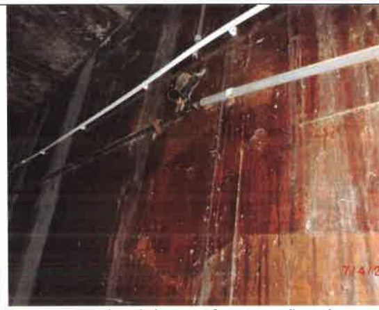
Fot. – 88 (Zbiorniki wody deszczowej) – nieczynne okablowanie do demontażu i utylizacji.
