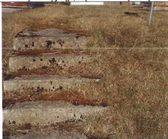
Fot. 30 – schody zewnętrzne do oczyszczenia i konserwacji.
