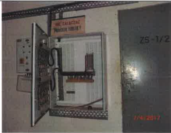
Fot. – 67 (Poziom -2.50) – komunikacja. Nieczynna rozdzielnica.
