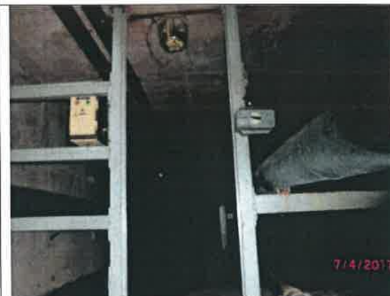
Fot. – 102 (Poziom -6.10) – wyjście z tunelu technologicznego – do zabezpieczenia kratą z zamknięciem.
