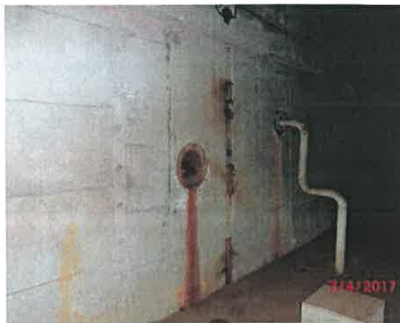
Fot. – 98 (Poziom -6.10) – nieczynne rurociągi do odcięcia, otwory do zamurowania i trwałego zabezpieczenia.
