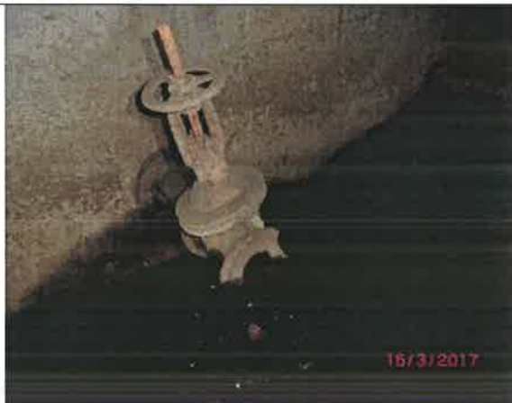
Fot. – 105 (Poziom -12.10) – nieczynna hala pomp – do uprzątnięcia. Istn. zasuwę nieużytkowane - do zabezpieczenia, króćce do zaślepienia.
