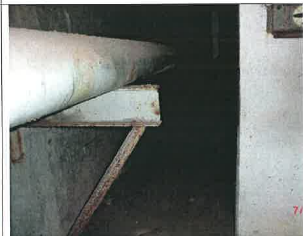
Fot. – 96 (Poziom -6.10) – nieczynny rurociąg tłoczny ścieków sanitarnych – do odcięcia zabezpieczenia końcówki, demontażu i utylizacji.
