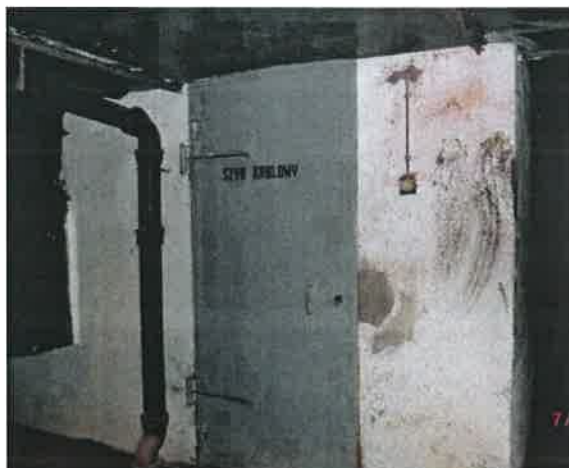
Fot. – 97 (Poziom -6.10) – szyb kablowy – zamek w drzwiach do uzupełnienia + klucze.
