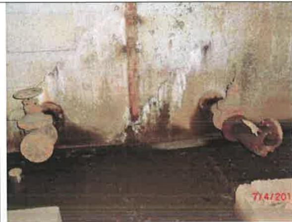
Fot. – 106 (Poziom -12.10) – nieczynna hala pomp – do uprzątnięcia. Istn. zasuwę nieużytkowane - do zabezpieczenia, króćce do zaślepienia.
