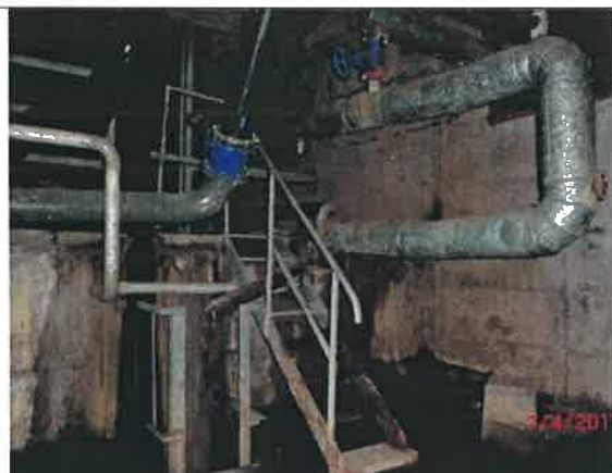
Fot. – 101 (Poziom -6.10) – Schody do odczyszczenia, zabezpieczenia antykorozyjnego i pomalowania. Pomieszczenie do uprzątnięcia.
