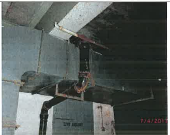
Fot. – 93 (Poziom -6.10) – kanał wentylacyjny – do demontażu i utylizacji. Rura kanalizacyjna do odczyszczenia i oznakowania.
