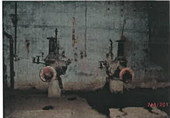
Fot. – 104 (Poziom -12.10) – nieczynna hala pomp – do uprzątnięcia. Istn. zasuwę do ewentualnego demontażu i utylizacji lub do zabezpieczenia. Otwory do trwałego zaślepienia.
