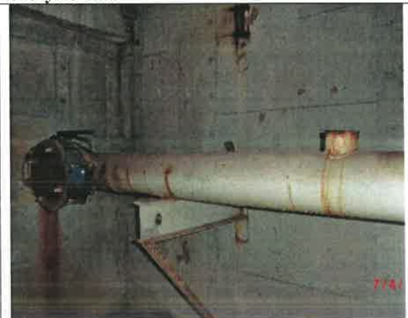
Fot. – 94 (Poziom -6.10) – nieczynny rurociąg tłoczny ścieków sanitarnych – do odcięcia zabezpieczenia końcówki, demontażu i utylizacji.
