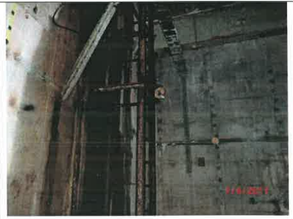
Fot. – 112 (Poziom -12.10) – nieczynna hala pomp – do uprzętnięcia. Drabina ewakuacyjna do oczyszczenia, zabezpieczenia antykorozyjnego i pomalowania.
