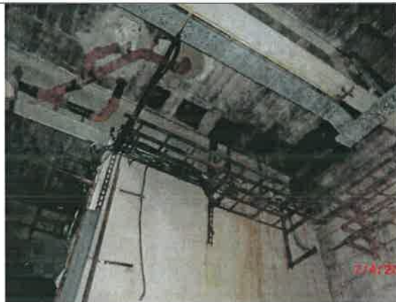
Fot. – 111 (Poziom -12.10) – nieczynna hala pomp – do uprzętnięcia. Do uzupełnienia oświetlenie. Drabinki kabli elektrycznych – do demontażu i utylizacji.
