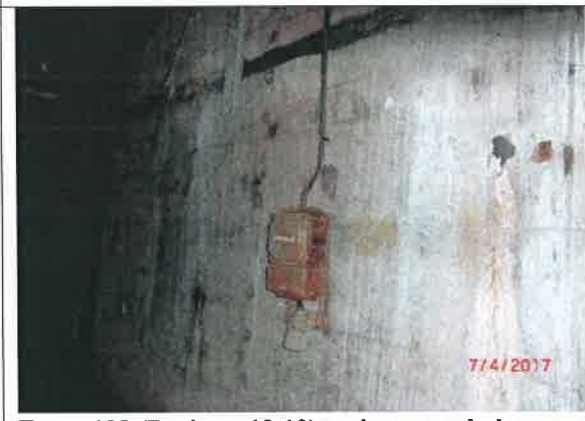
Fot. – 108 (Poziom -12.10) – nieczynna hala pomp – do uprzątnięcia. Istn. skrzynka rozdzielcza – do demontażu i utylizacji.
