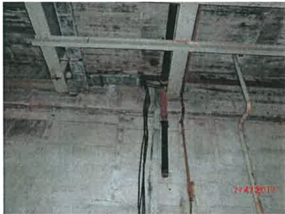
Fot. – 109 (Poziom -12.10) – nieczynna hala pomp – do uprzętnięcia. Istn. nieużytkowane kable – do demontażu i utylizacji.
