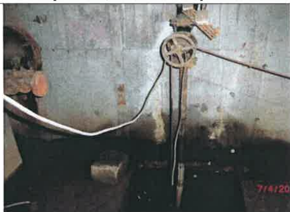
Fot. – 107 (Poziom -12.10) – nieczynna hala pomp – do uprzątnięcia. Istn. pompa do odcieków - do włączenia w nowy układ zasilania elektrycznego i sterowania. Zasuwa do konserwacji. Rurociągi do oznakowania.
