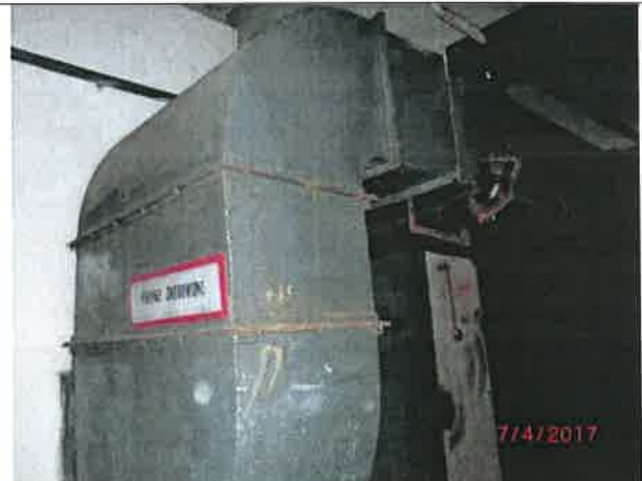
Fot. – 92 (Poziom -6.10) – kanał wentylacyjny – do demontażu i utylizacji. Rura kanalizacyjna do odczyszczenia i oznakowania.
