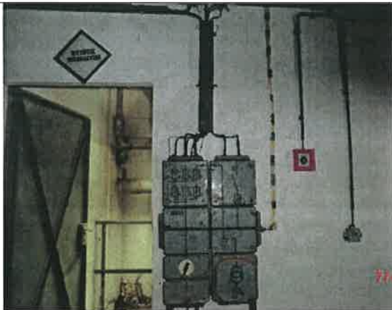
Fot. – 91 (Poziom -6.10) – rozdzielnica elektryczna – do demontażu i utylizacji. Do uzupełnienia oświetlenie całego poziomu.
