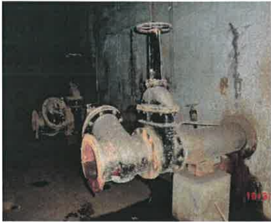
Fot. – 103 (Poziom -12.10) – nieczynna hala pomp – do uprzątnięcia. Istn. zasuwę do ewentualnego demontażu i utylizacji lub do zabezpieczenia. Otwory do trwałego zaślepienia.
