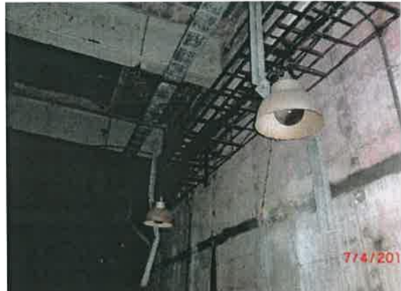
Fot. – 110 (Poziom -12.10) – nieczynna hala pomp – do uprzętnięcia. Do uzupełnienia oświetlenie. Istniejące oprawy do wymiany na ledowe.
