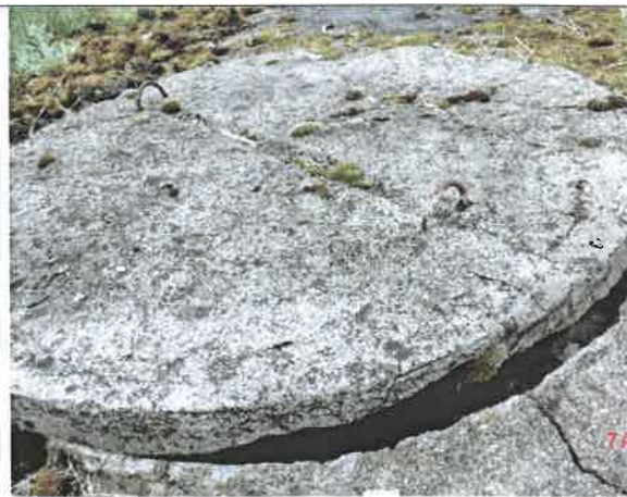
Fot. 14 – Obudowa wjazdu do naprawy. Pokrywa – do wymiany.
