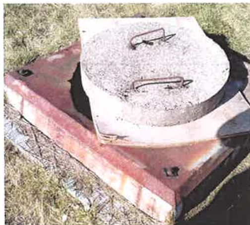
Fot. 20 – Otwór po wywietrzaku zbiornika – do zabezpieczenia/przykrycia.
