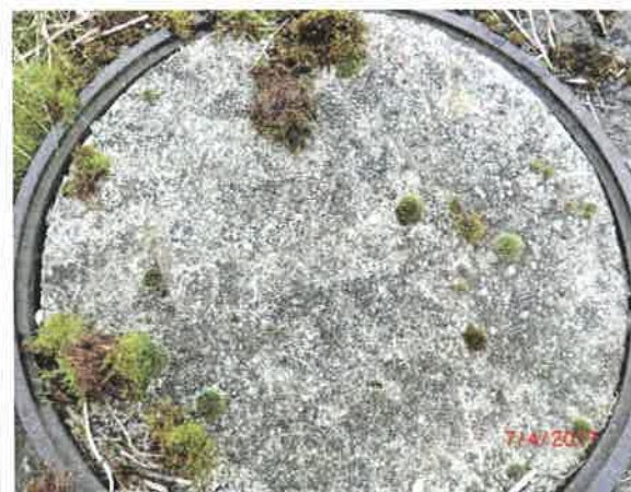
Fot. 16 – Pokrywa wjazdu – do wymiany.
