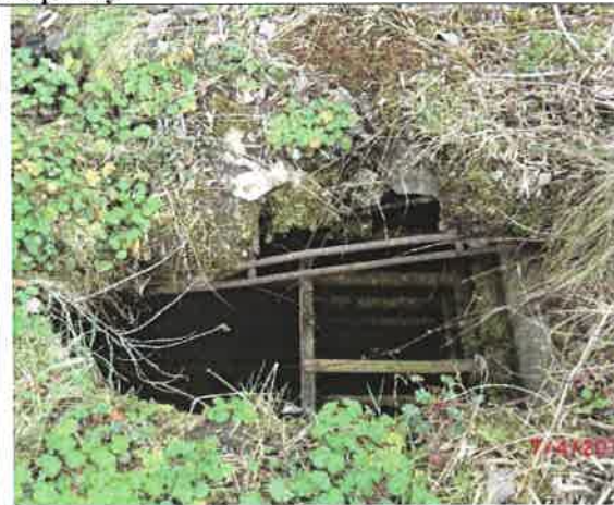
Fot. 10 – przykrycie kanału technologicznego – do naprawy.
