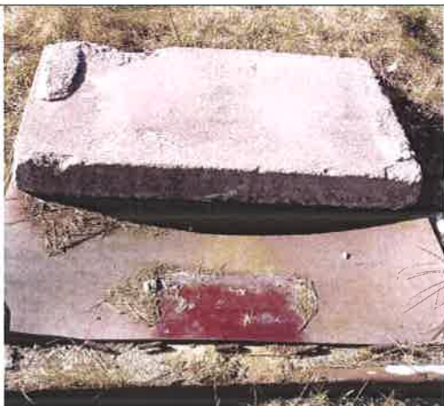
Fot. 21 – Otwór po wywietrzaku zbiornika – do zabezpieczenia/przykrycia.
