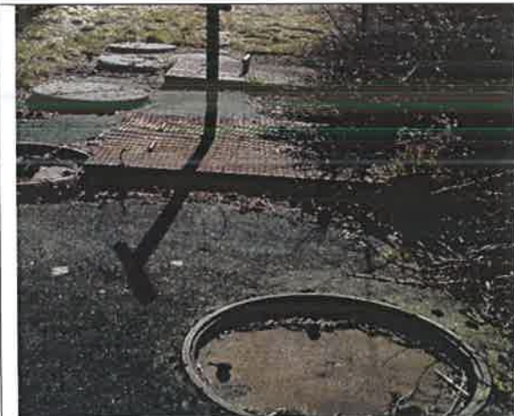
Fot. 12 – Pokrywy włazów – do wymiany.
