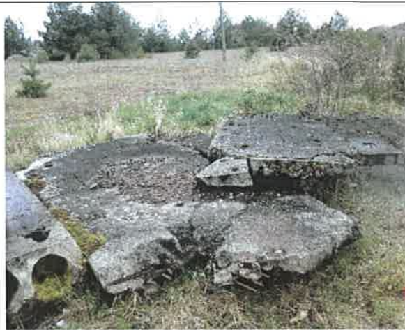
Fot. 8 – przykrycie kanału technologicznego – do naprawy.
