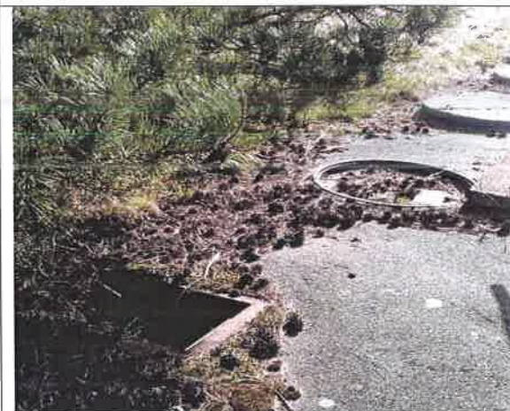
Fot. 18 – pokrywy wjazdów i rewizji – do wymiany i uzupełnienia. Do uzupełnienia kratka wentylująca komorę rozdziału.
