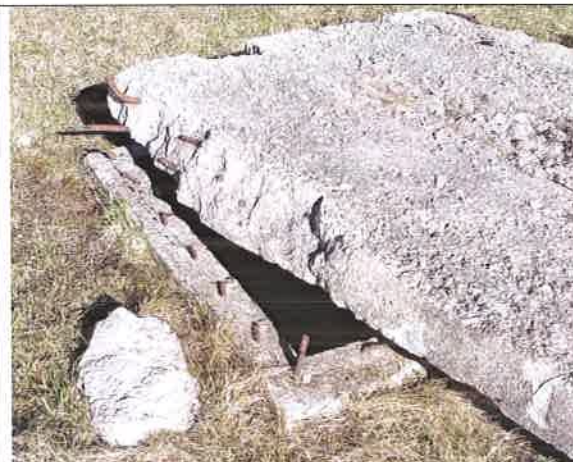
Fot. 22 – Otwór po wywietrzaku zbiornika – do zabezpieczenia/przykrycia.
