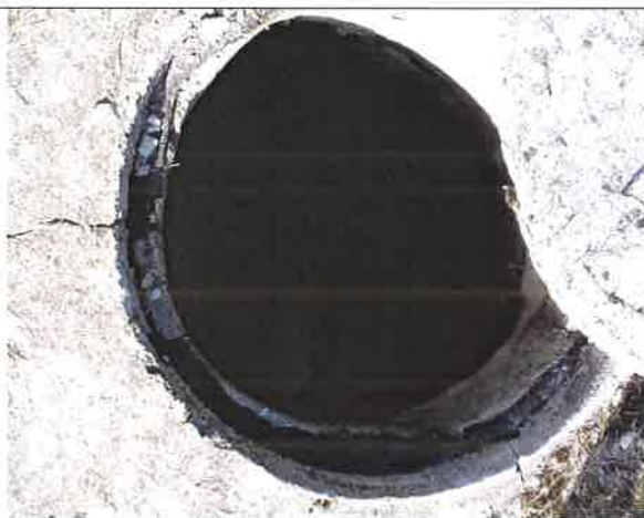
Fot. 15 – Obudowa wjazdu do naprawy. Pokrywa – do wymiany.
