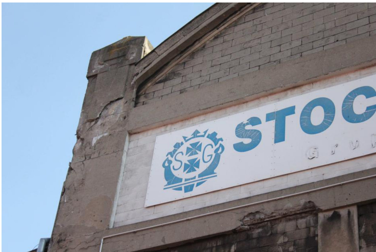
Fot. 9 elewacja południowa uszkodzone detale
