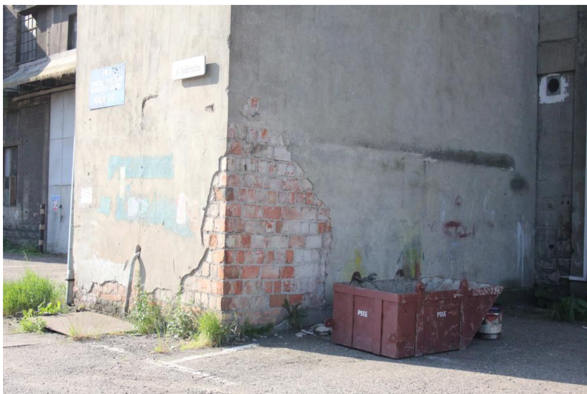
Fot. 10 elewacja północna ubytki tynku
