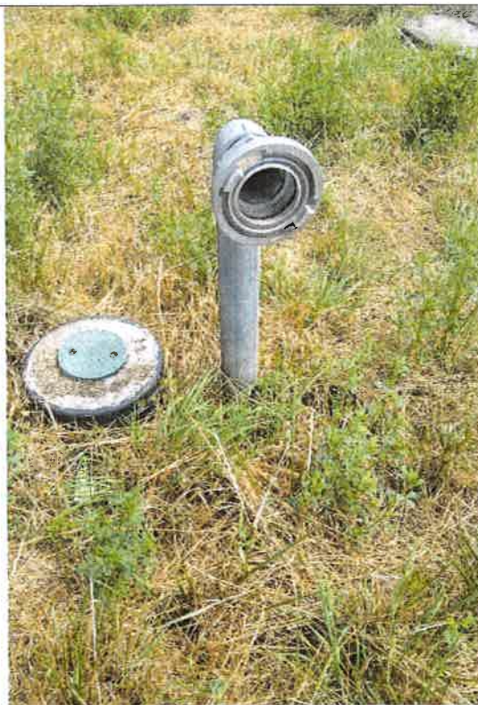
14/ZR1 – zasuwa i przyłącze wody do instalacji płuczącej osadnika.
