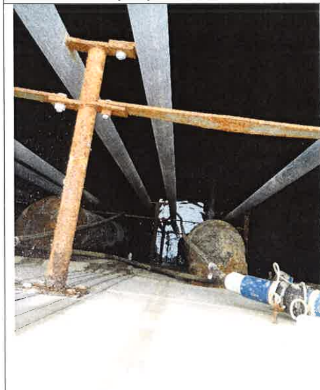
3/ZR1 – komora pomp
