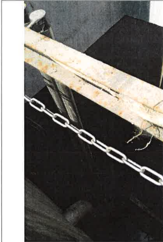
1/ZR2 – komora pomp
