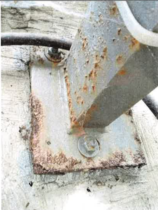
3/ZR2 – komora pomp – mocowanie przewodnic pomp
