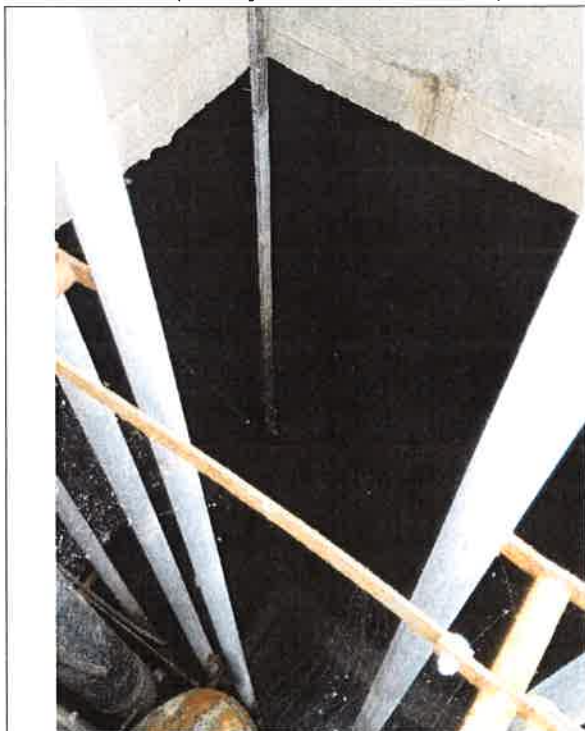
1/ZR1 – komora pomp
