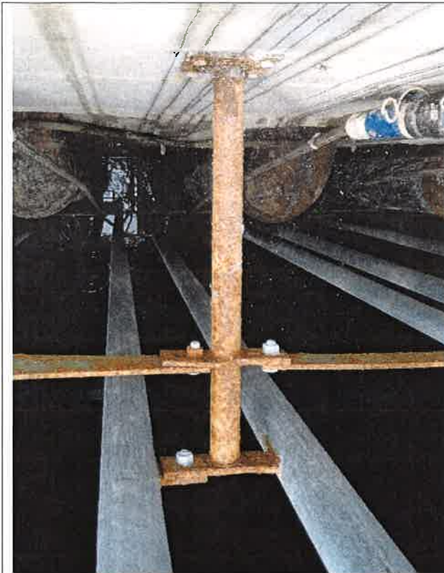
5/ZR1 – komora pomp
