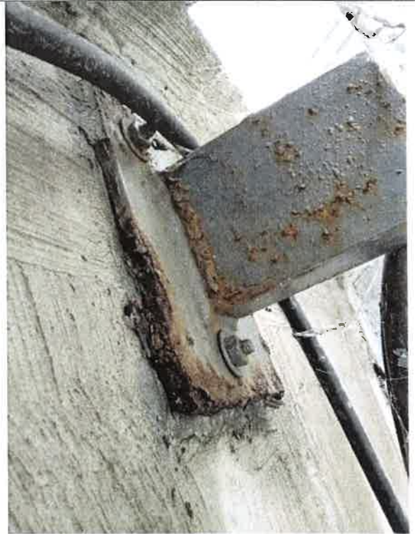
2/ZR2 – komora pomp – mocowanie przewodnic pomp
