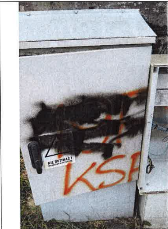
12/ZR1 – szafka sterownicza przy komorze pomp
