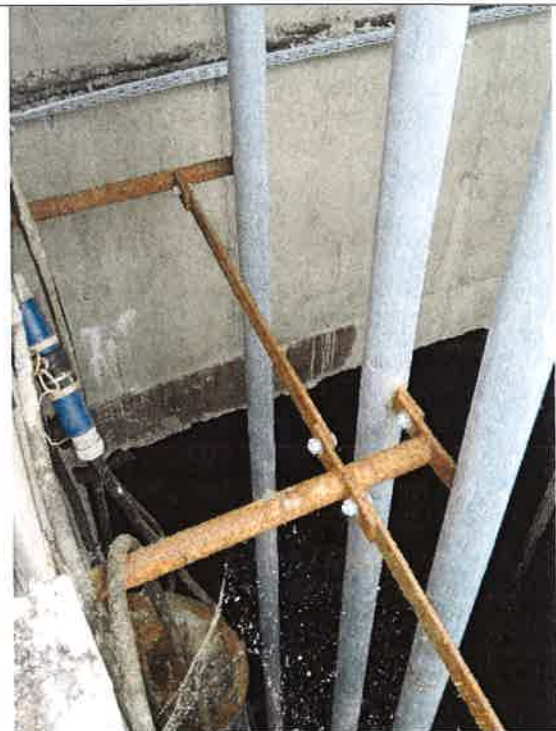
2/ZR1 – komora pomp
