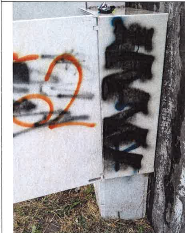
11/ZR1 – szafka sterownicza przy komorze pomp
