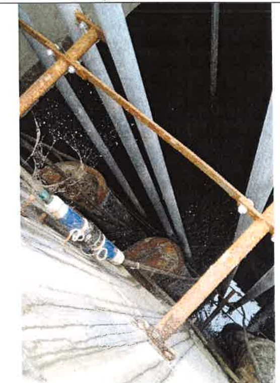
4/ZR1 – komora pomp
