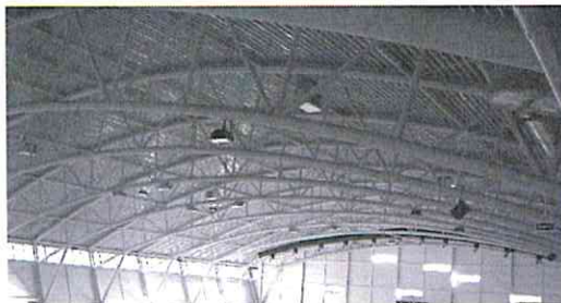
Zdjęcie 1: Widok z dołu na konstrukcję nośną dachu wykonaną ze stalowych blach trapezowych.
