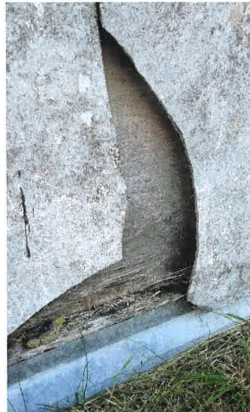
Fot. 8 – popękana okładzina elewacji budynku.
