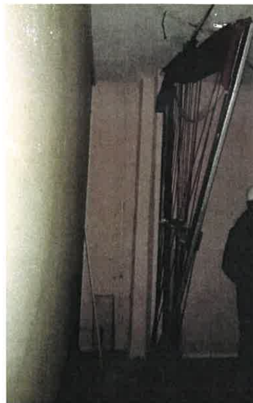
Fot. 16 – żaluzja p.poż na łączeniu budynków F i G.
