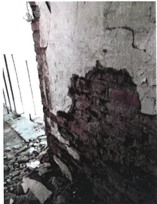
Fot. 34 – skorodowane ściany nośne w bud. B
