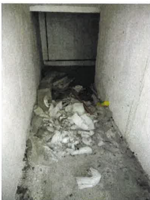
Fot. 9 – pomieszczenie techniczne pod schodami (F).
