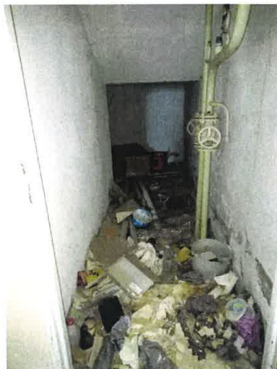
Fot. 27 – pomieszczenie techniczne pod schodami (część murowana E).
