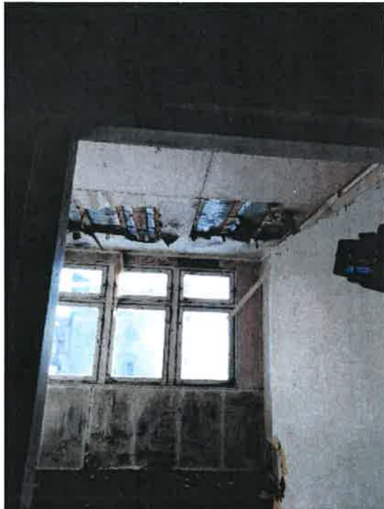
Fot. 27 – zniszczony strop w części drewnianej (A).
