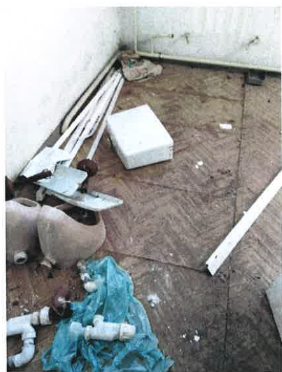
Fot. 18 – pozostałości wyposażenia pomieszczeń.
