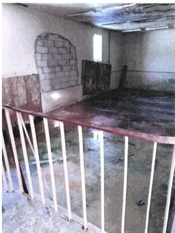
Fot. 16 – pomieszczenie techniczne (E/1)
