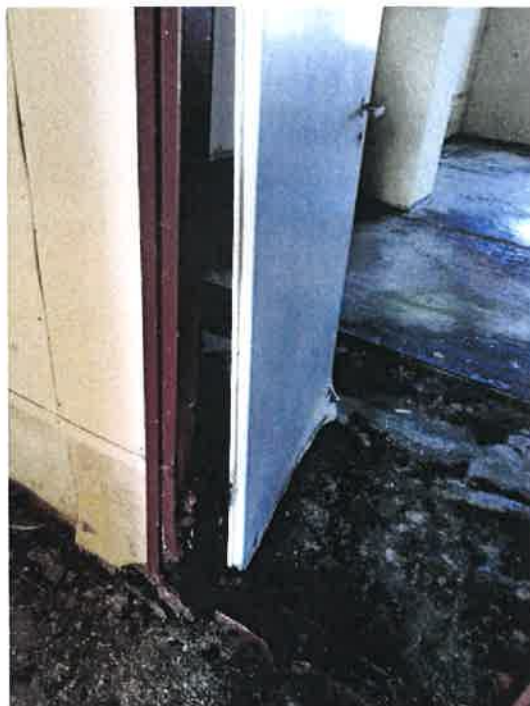
Fot. 21 – uszkodzona ściana działowa (część drewniana E)
