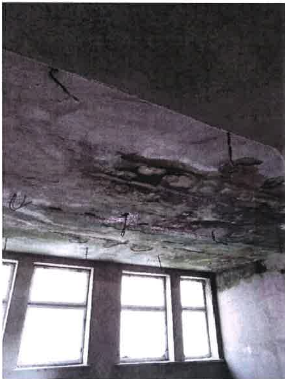
Fot. 17 – strop w pomieszczeniu technicznym (część murowana A).
