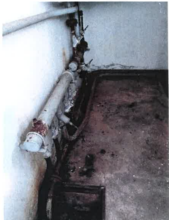
Fot. 11 – rozdzielacz c.o. (część murowana D).
