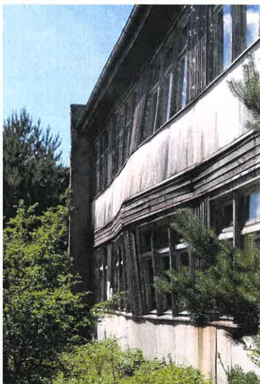
Fot. 7 – odspojona od konstrukcji elewacja zachodnia budynku G.
