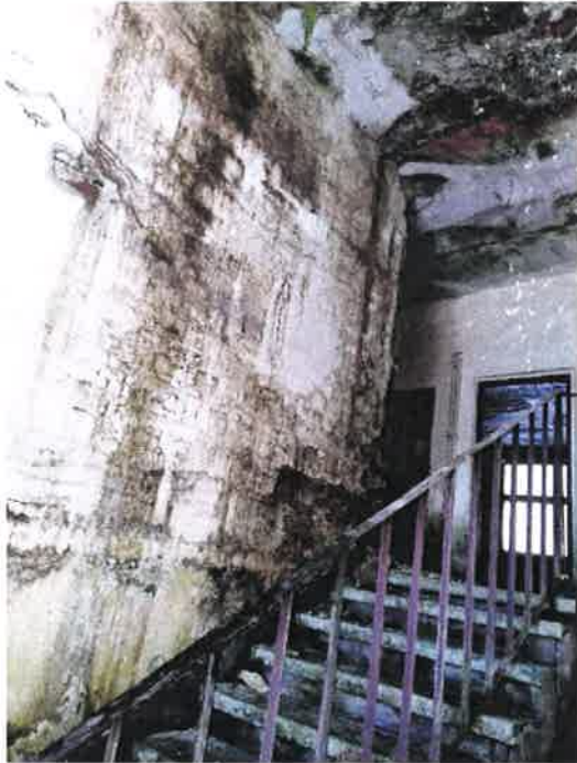
Fot. 31 – zniszczona wilgocią klatka schodowa (B).
