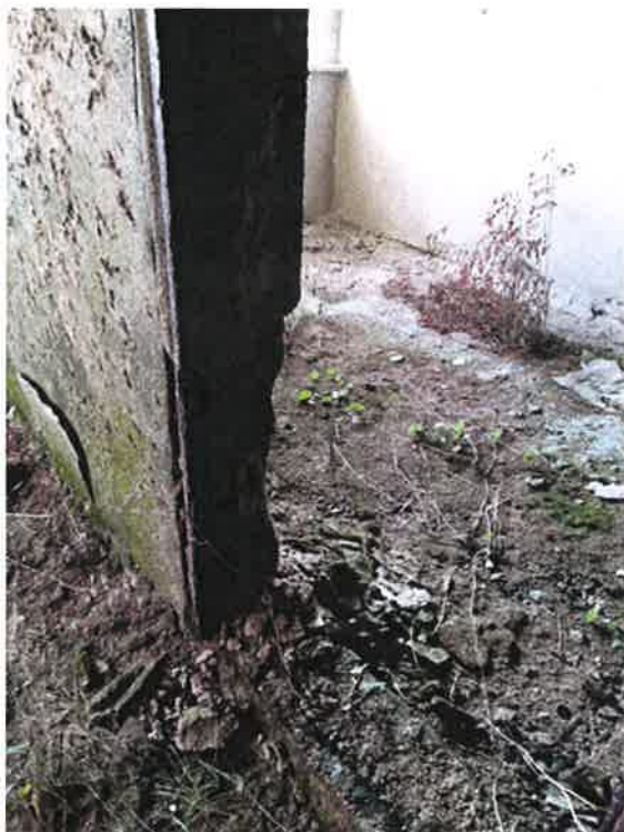
Fot. 19 – zniszczona przez wilgoć posadzka i ściany wewnątrz budynku A.
