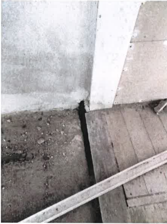
Fot. 23 – odspojone na połączeniu części drewnianej z klatką schodową budynku A.
