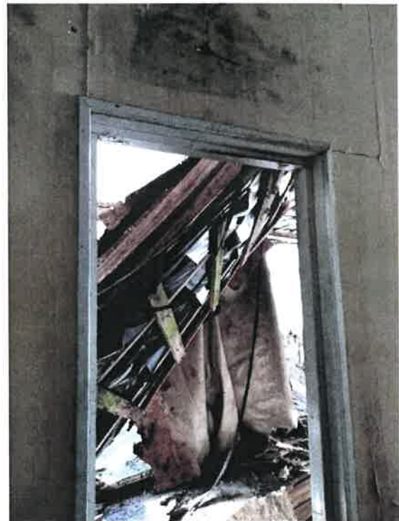
Fot. 20 – zerwany strop w budynku G.
