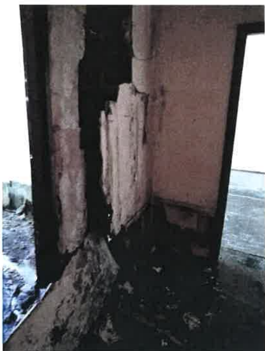
Fot. 22 – uszkodzona ściana działowa (część drewniana E)
