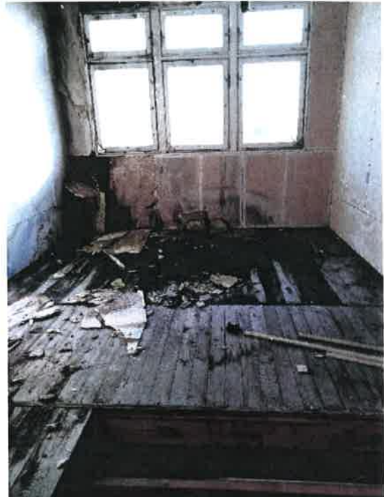
Fot. 28 – zniszczona przez wilgoć stolarka w bud. A.
