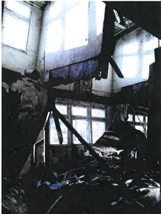
Fot. 19 – zerwany strop w budynku G.
