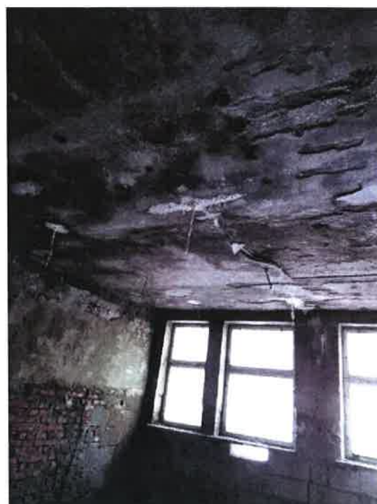
Fot. 22 – zniszczony strop w murowanej części budynku A.
