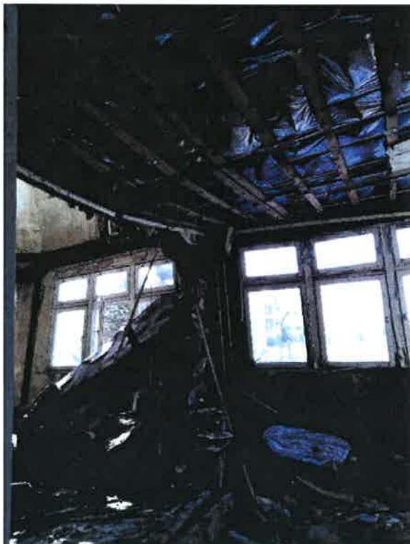
Fot. 21 – zerwany strop w budynku G.
