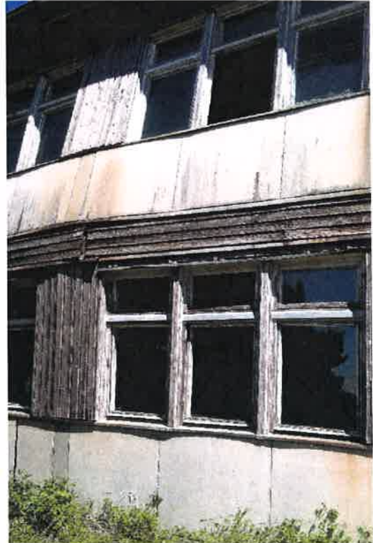
Fot. 6 – odspojona od konstrukcji elewacja zachodnia budynku G.
