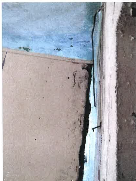
Fot. 19 – odspojona ściana działowa (E/1)
