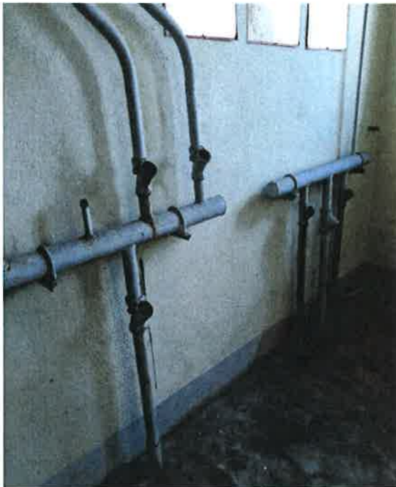
Fot. 9 – zniszczone rozdzielacze c.o. (część murowana).
