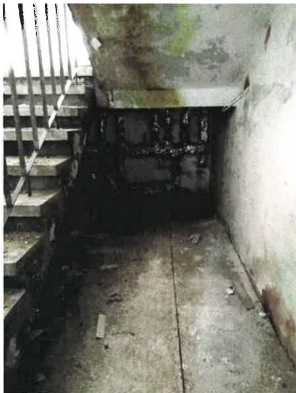
Fot. 29 – rozdzielacze c.o. pod schodami w bud. B
