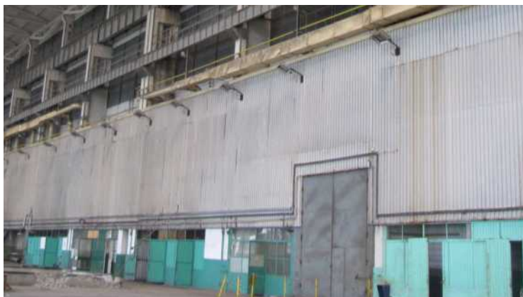
Widok istniejącej ściany dzielącej nawę AB i C od strony nawy C
