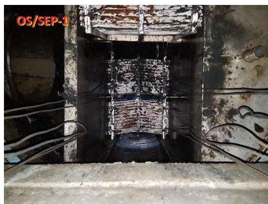
Fot. 66 – Separator SEP1.
