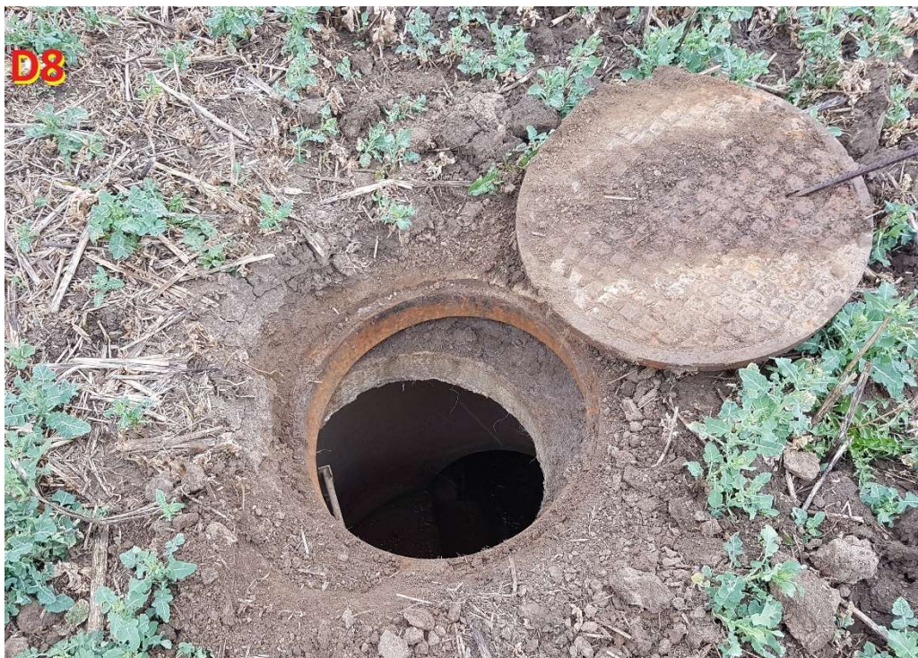
Fot. 27 – Przekrzywiony kołnierz na studni D8.
