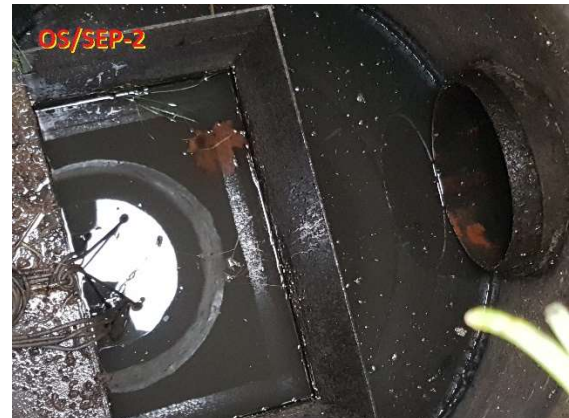
Fot. 68 – Separator SEP2.
