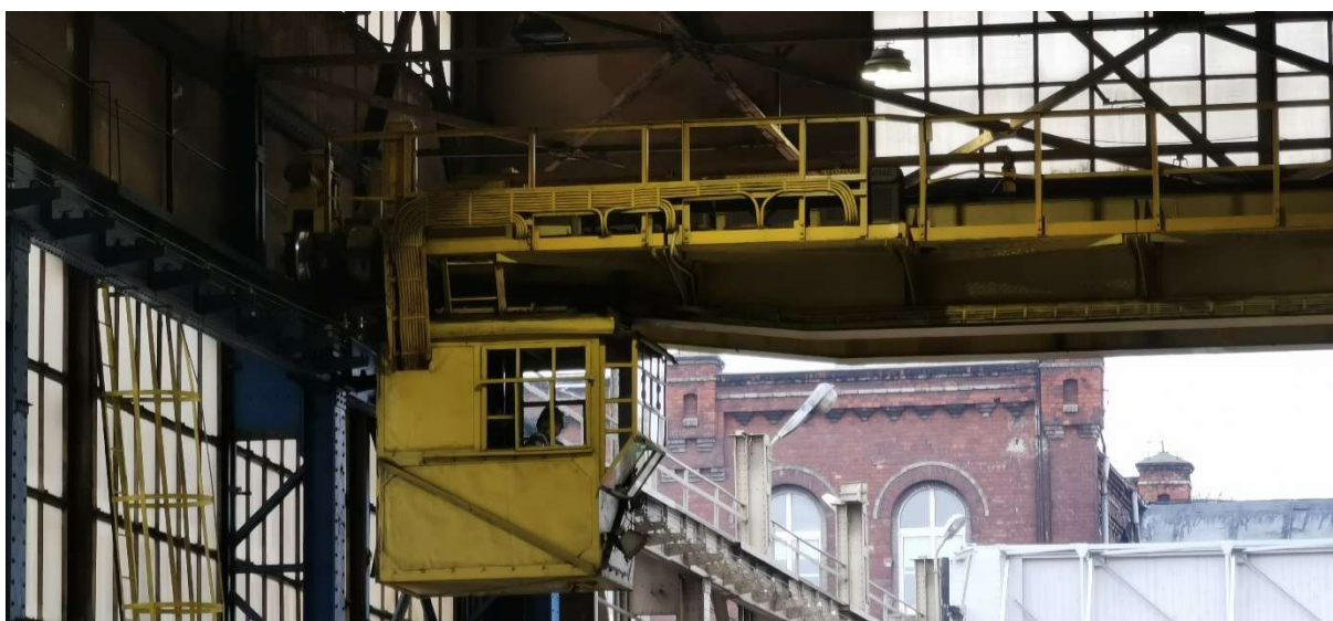
Suwnica pracująca przy otwartej przejazdnej zasłonie otworu suwnicowego, zlokalizowanej w północnej elewacji szczytowej
