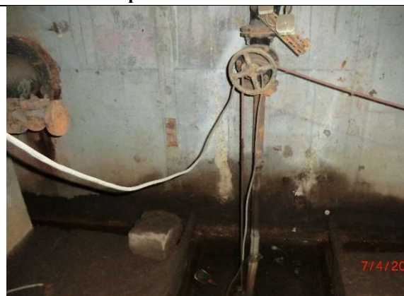
Fot. – 107 (Poziom -12.10) – nieczynna hala pomp Istn. pompa do odcieków - do włączenia w nowy układ zasilania elektrycznego i sterowania. Zasowa do konserwacji. Rurociągi do oznakowania.
