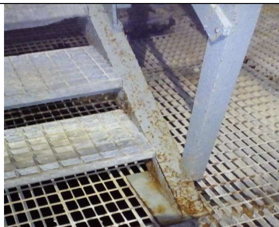
Fot. – 80 (Poziom -2.50) – Galeria – wejście do zbiorników wód opadowych - istn. schody wejściowe – do wyczyszczenia, zabezpieczenia antykorozyjnego i pomalowania.
