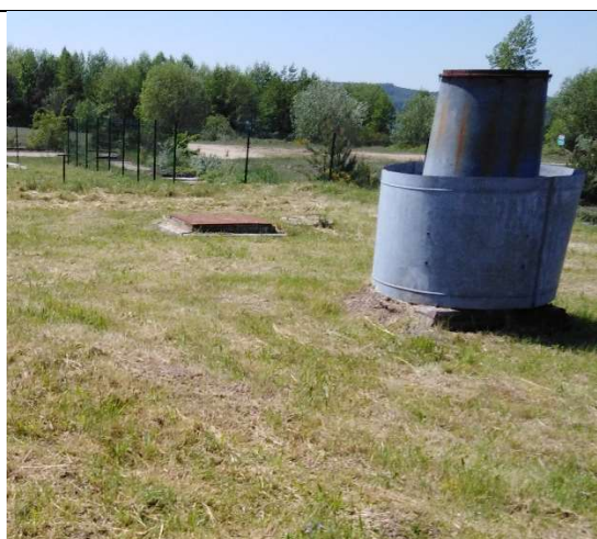
Fot. 21 – Wywietrzak zbiornika – do wymiany.
