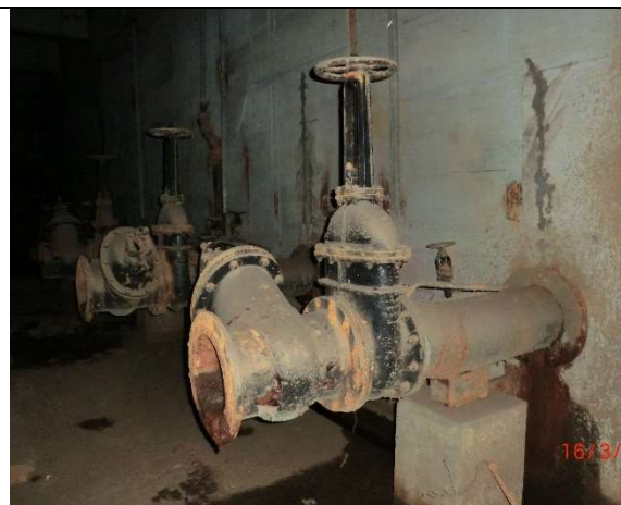
Fot. – 103 (Poziom -12.10) – nieczynna hala pomp. Istn. zasowy do ewentualnego demontażu i utylizacji lub do zabezpieczenia. Otwory do trwałego zaślepienia.
