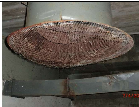
Fot. – 74 (Poziom -2.50) – Galeria – istn. osłona wywietrzaka wentylatorowego do wymiany/likwidacji.
