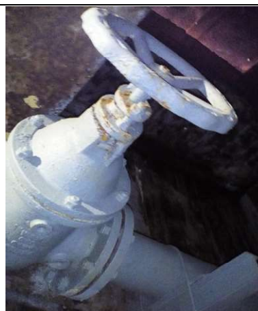
Fot. – 82 (Zbiorniki wody deszczowej) – rurociągi systemu płuczącego.
