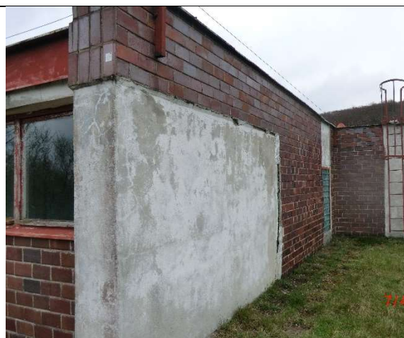
Fot. 34 – Elewacja do uzupełnienia i zabezpieczenia. Drabina wjazdowa na dach do przełożenia od strony działki F-13 lub wykonania dodatkowo.
