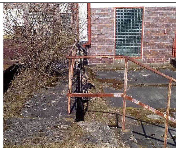
Fot. 33 – Schody, poręcz i balustrada od strony muru oporowego (dz. 199/154) do odczyszczenia i pomalowania.
