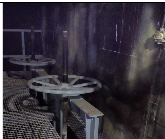
Fot. – 89 (Zbiorniki wody deszczowej) – zasady przelewowe zbiornikowe
