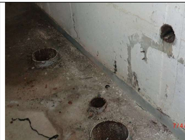
Fot. – 73 (Poziom -2.50) – Korytarz prowadzący do zbiorników – istn. otwory w stropie i ścianie do zamurowania.
