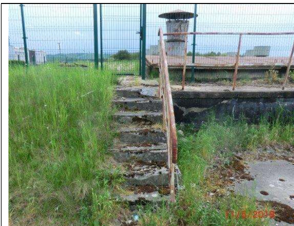
Fot. 13 – Zniszczone schody od strony działki 199/154.
