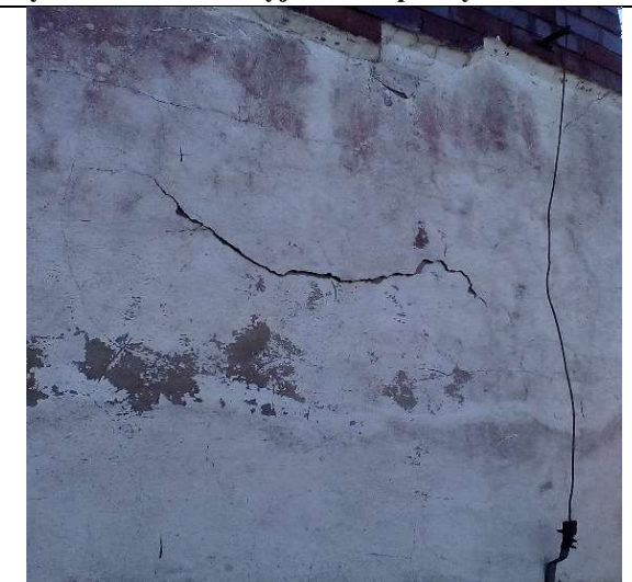
Fot. 42 – Elewacja do naprawy i otynkowania. Instalacja odgromowa do wymiany.
