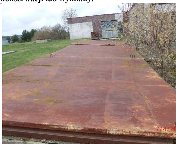
Fot. 28 – pokrywy luków montażowych – do konserwacji lub wymiany
