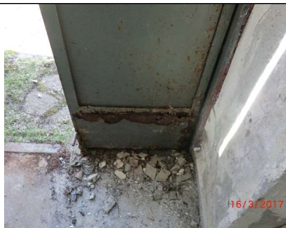
Fot. – 44 (Poziom +1.10) – drzwi zewnętrzne do wymiany.
