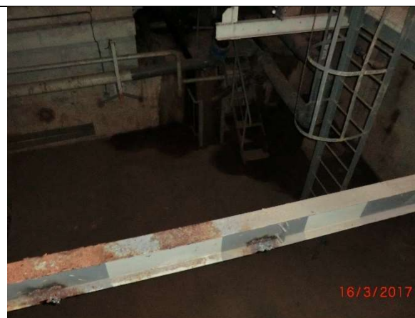
Fot. – 76 (Poziom -2.50) – Galeria – istn. drabina ewakuacyjna z poziomu -6.10 – do wyczyszczenia, zabezpieczenia antykorozyjnego i pomalowania.
