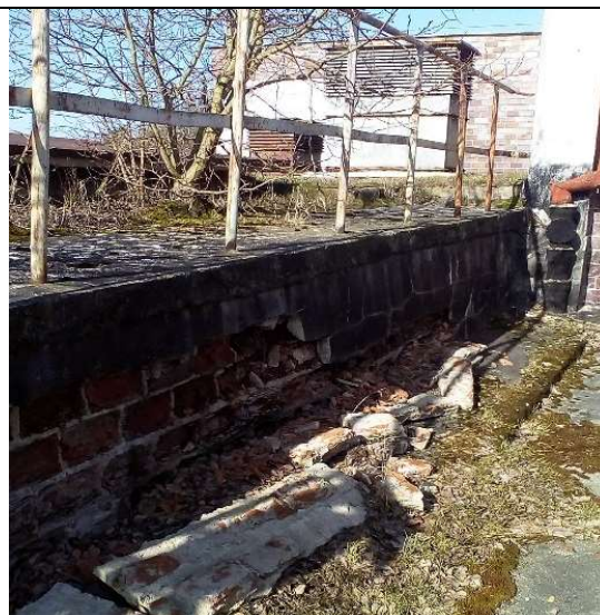
Fot. 32 – Zniszczony murek oporowy na granicy działek 199/191 i 199/154.
