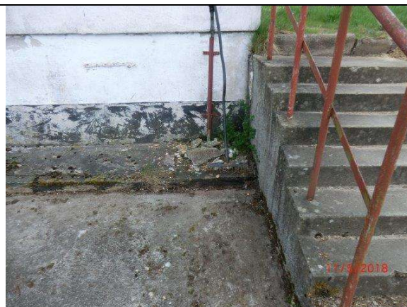
Fot. 20 – Schody wejściowe do budynku i zniszczona instalacja odgromowa.
