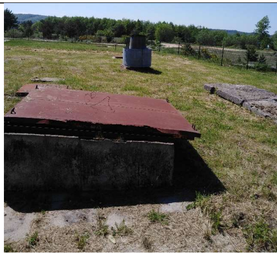
Fot. 6 (Teren) – Zniszczone i wybrakowane urządzenia wentylacyjne oraz skorodowane pokrywy luków montażowych.
