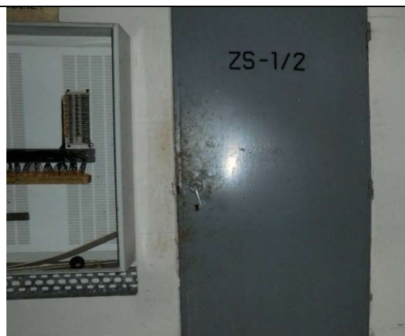
Fot. – 68 (Poziom -2.50) – komunikacja. Wejście do wyłączonych z użytkowania zbiorników ścieków sanitarnych – do zabezpieczenia i oznakowania.
