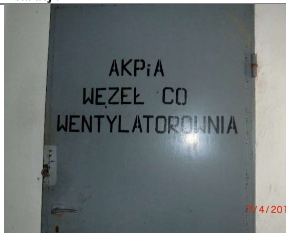
Fot. – 60 (Poziom -2.50) – pomieszczenie wentylatorowni i AKPiA.
