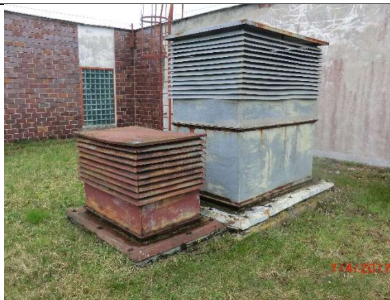
Fot. 29 – Czerpnia wentylacyjna – do odtworzenia lub likwidacji. Otwory po czerpni do trwałego zabezpieczenia.
