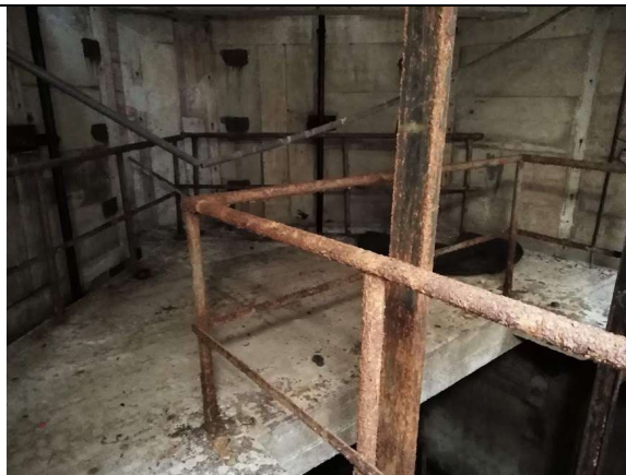
Fot. 11 (Teren) – Skorodowane balustrady w komorze rozdziału.
