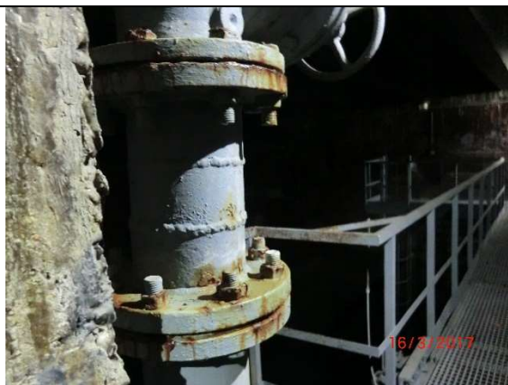
Fot. – 81 (Zbiorniki wody deszczowej) – rurociągi systemu płuczącego
