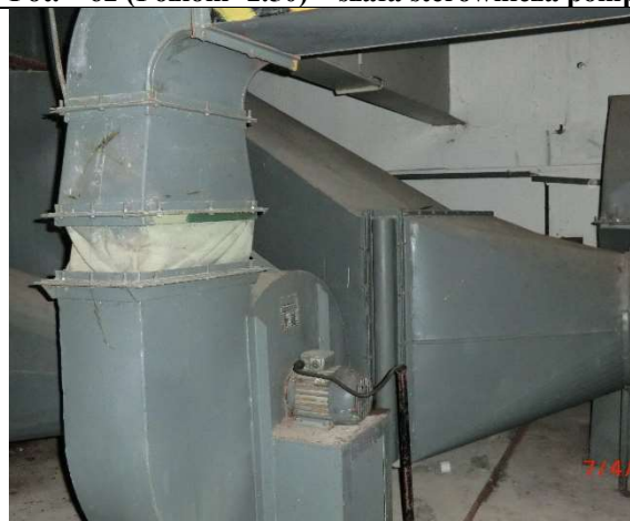
Fot. – 64 (Poziom -2.50) – pomieszczenie wentylatorowni i AKPiA – nieczynne kanały wentylacyjne – do demontażu i utylizacji.
