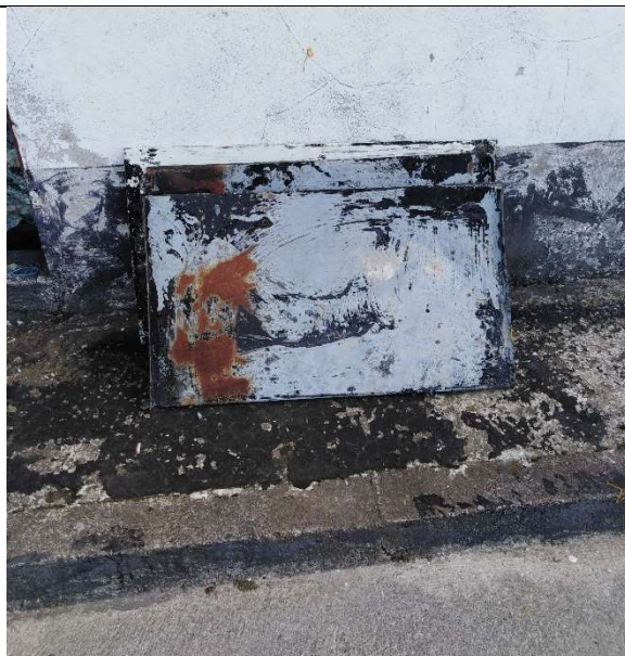
Fot. 41 – Zniszczona elewacja i fragment osłony attyki.
