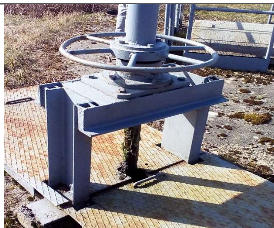
Fot. 18 – pokrywy luków montażowych i trzpienie zasuw na komorze rozdziału.
