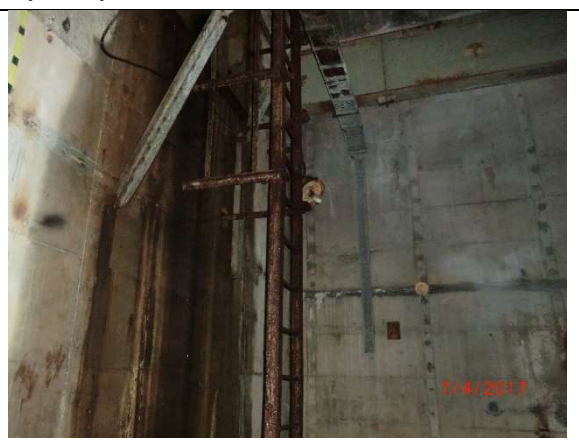
Fot. – 112 (Poziom -12.10) – nieczynna hala pomp Drabina ewakuacyjna do oczyszczenia, zabezpieczenia antykorozyjnego i pomalowania.
