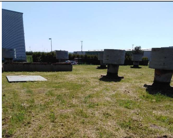
Fot. 25 – Wywiewczaki zbiornika – do wymiany.
