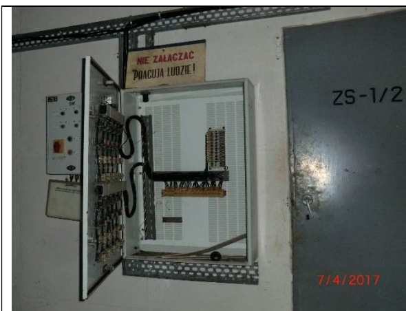
Fot. – 67 (Poziom -2.50) – komunikacja. Nieczynna rozdzielnica.
