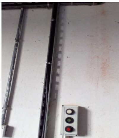
Fot. – 49 (Poziom +1.10) – instalacja sterowania wentylacją mechaniczną.
