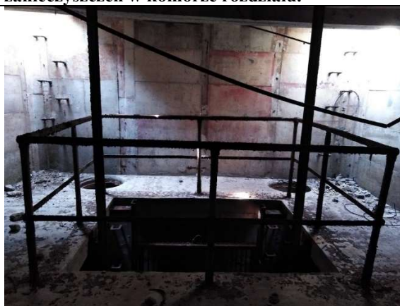
Fot. 10 (Teren) – balustrada nad komorą krat i poluzowane osłony kabli.
