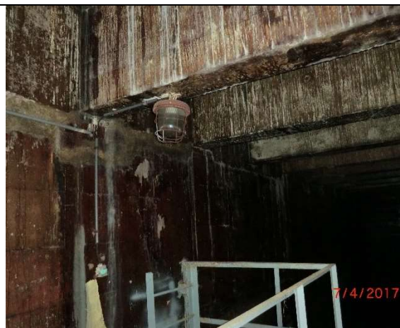
Fot. – 86 (Zbiorniki wody deszczowej) – istniejące oświetlenie do wymiany i uzupełnienia oświetleniem ledowym (ok. 10 szt. opraw).
