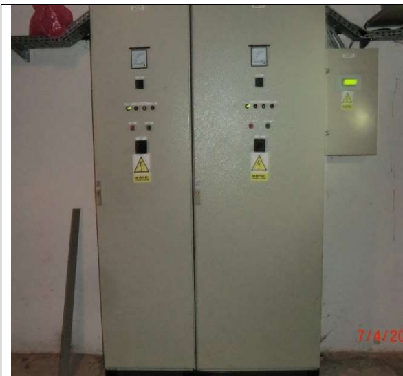
Fot. – 61 (Poziom -2.50) – pomieszczenie wentylatorowni i AKPiA – szafa sterownicza pomp – do rozbudowy.
