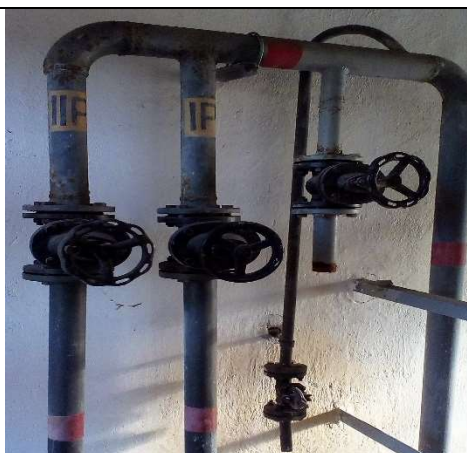
Fot. – 51 (Poziom +1.10) – rurociągi odwodnienia zbiorników
