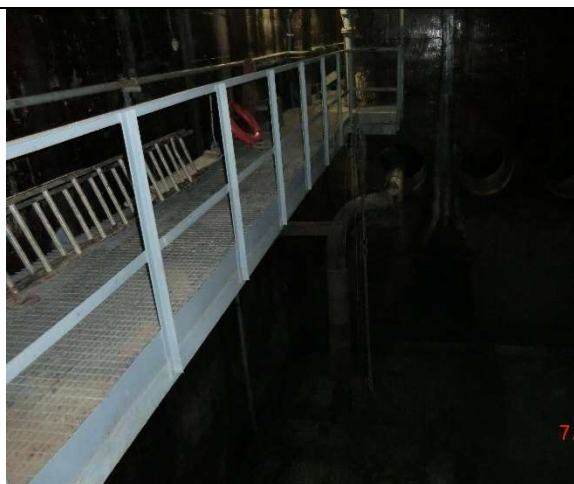
Fot. – 83 (Zbiorniki wody deszczowej) – pomost do oczyszczenia, zabezpieczenia antykorozyjnego i pomalowania.
