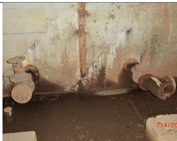
Fot. – 106 (Poziom -12.10) – nieczynna hala pomp Istn. zasowy nieużytkowane - do zabezpieczenia, króćce do zaślepienia.
