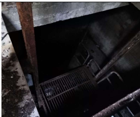
Fot. 9 (Teren) – skorodowane prowadnice kraty w komorze rozdziału.
