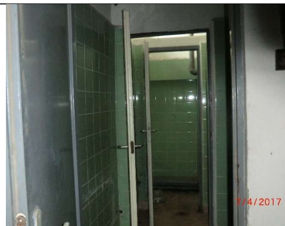
Fot. – 69 (Poziom -2.50) – komunikacja. Nieużytkowane pom. Sanitarne.
