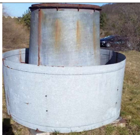
Fot. 22 – Wywietrzaki zbiornika – do wymiany (razem 13 szt. wywietrzaków do wymiany)
