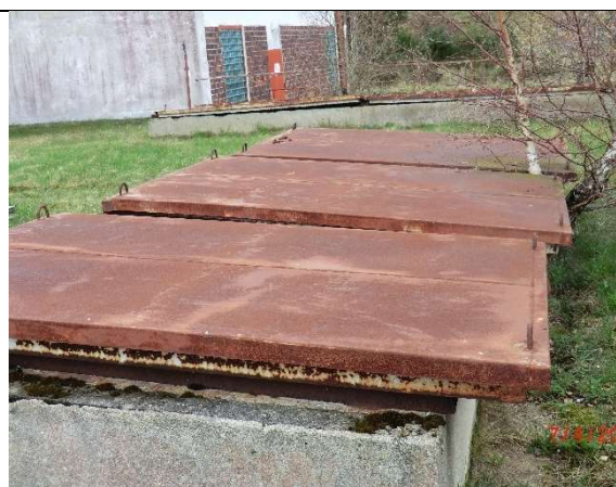
Fot. 27 – pokrywy luków montażowych – do konserwacji lub wymiany
