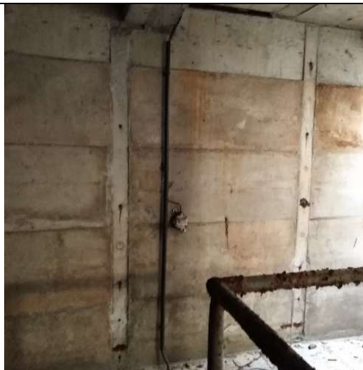
Fot. 12 – Resztki zniszczonej instalacji elektrycznej w komorze rozdziału.
