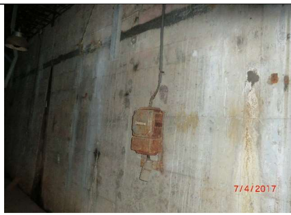
Fot. – 108 (Poziom -12.10) – nieczynna hala pomp Istn. skrzynka rozdzielcza.
