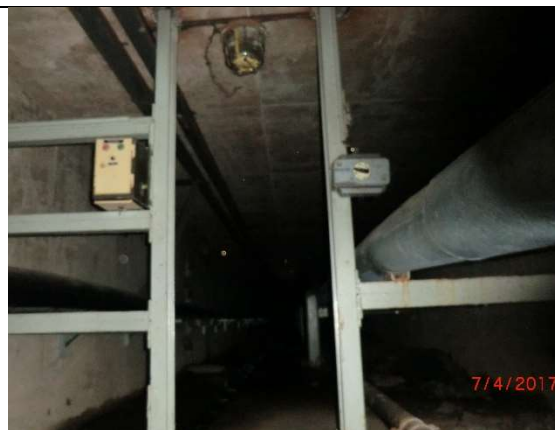
Fot. – 102 (Poziom -6.10) – wyjście z tunelu technologicznego – do zabezpieczenia kratą zamykaną na klódkę.
