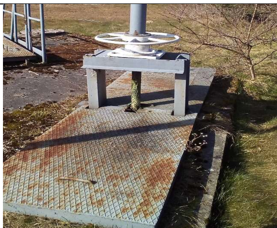
Fot. 17 – pokrywy luków montażowych i trzpienie zasuw na komorze rozdziału.
