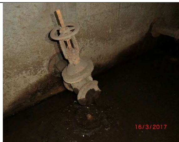
Fot. – 105 (Poziom -12.10) – nieczynna hala pomp Istn. zasowy nieużytkowane - do zabezpieczenia, króćce do zaślepienia.
