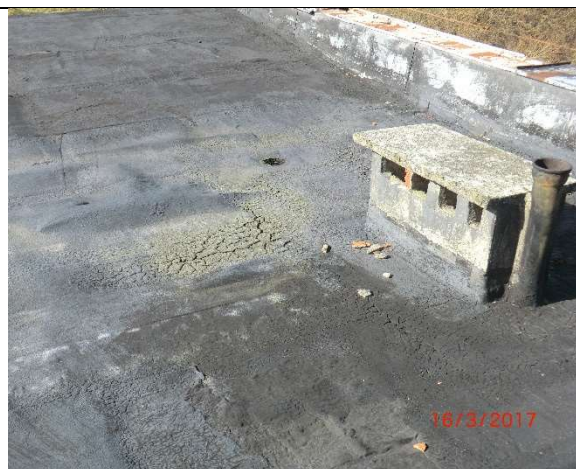
Fot. 40 – Pokrycie dachu do wymiany. Komin i wywiewka kanalizacyjna do naprawy.
