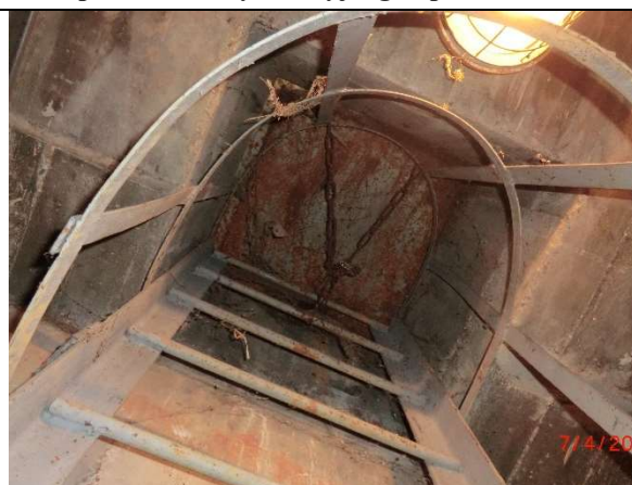
Fot. – 78 (Poziom -2.50) – Galeria – istn. drabina ewakuacyjna – do wyczyszczenia, zabezpieczenia antykorozyjnego i pomalowania.
