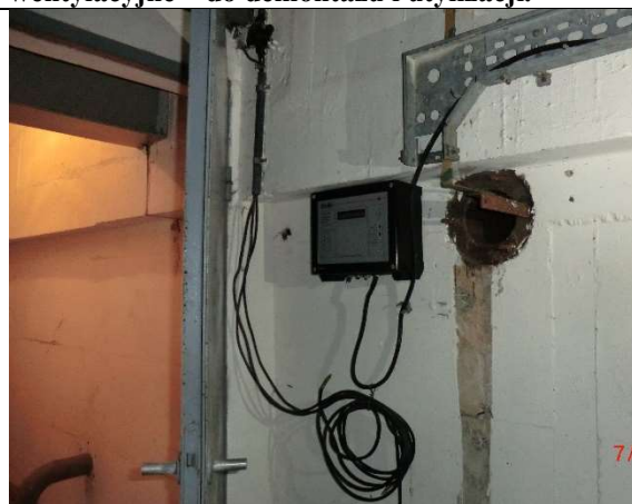
Fot. – 66 (Poziom -2.50) – komunikacja. Nieczynna instalacja sterowania wentylacją.
