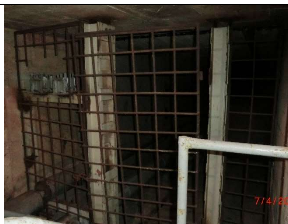
Fot. – 77 (Poziom -2.50) – Galeria – istn. krata zabezpieczająca wyjście z tunelu technologicznego – do odtworzenia i zamknięcia.
