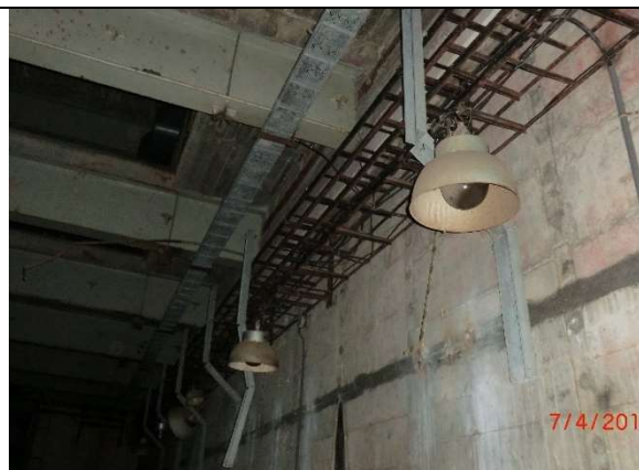
Fot. – 110 (Poziom -12.10) – nieczynna hala pomp Do uzupełnienia oświetlenie. Istniejące oprawy do wymiany na ledowe.
