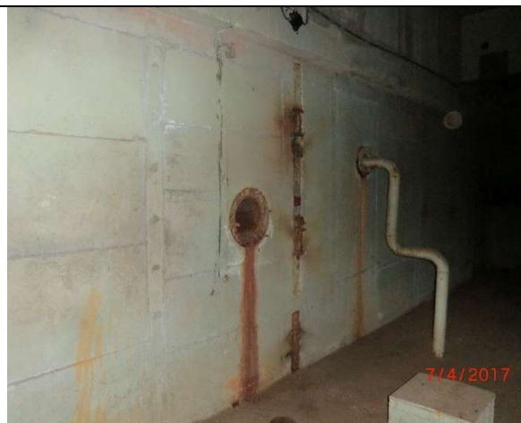
Fot. – 98 (Poziom -6.10) – nieczynne rurociągi i otwory w ścianie – do usunięcia i zabezpieczenia.
