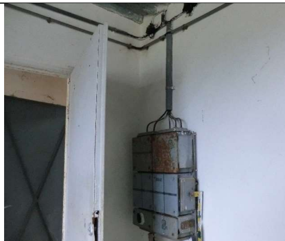
Fot. – 48 (Poziom +1.10) – rozdzielnica elektryczna w pomieszczeniu technicznym
