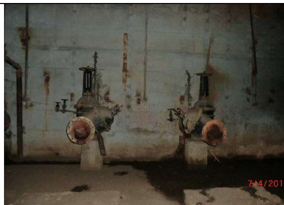
Fot. – 104 (Poziom -12.10) – nieczynna hala pomp Istn. zasowy do ewentualnego demontażu i utylizacji lub do zabezpieczenia. Otwory do trwałego zaślepienia.
