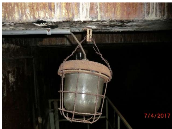
Fot. – 85 (Zbiorniki wody deszczowej) – istniejące oświetlenie do wymiany i uzupełnienia oświetleniem ledowym (ok. 10 szt. opraw).
