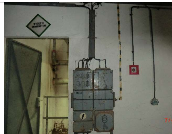
Fot. – 91 (Poziom -6.10) – rozdzielnica elektryczna. Do uzupełnienia oświetlenie całego poziomu.
