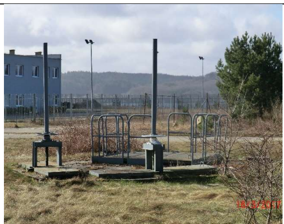
Fot. 16 – Widok na komorę rozdziału z zasuwami kierunkowymi.
