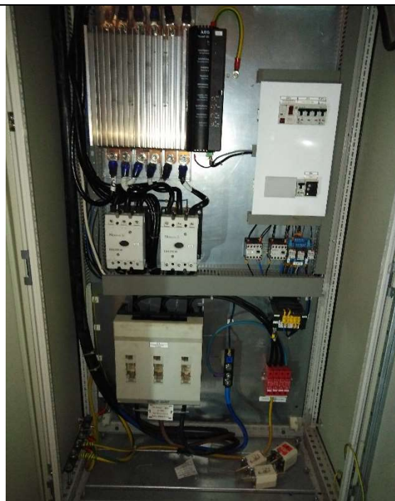
Fot. – 62 (Poziom -2.50) – szafa sterownicza pomp.
