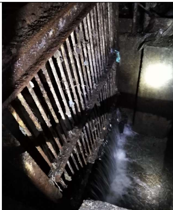
Fot. 8 (Teren) – krata do zatrzymywania zanieczyszczeń w komorze rozdziału.
