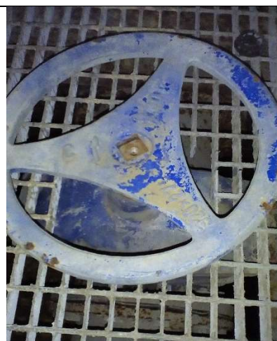
Fot. – 90 (Zbiorniki wody deszczowej) – zasada odcinająca na rurociągu tłocznym ścieków deszczowych
