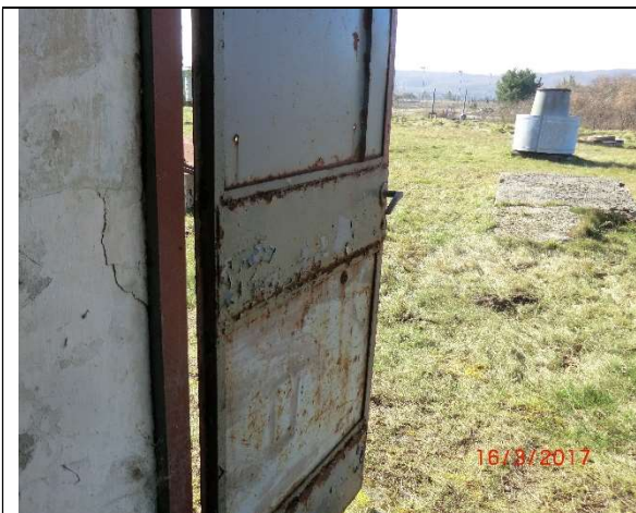
Fot. – 43 (Poziom +1.10) – drzwi zewnętrzne do wymiany.
