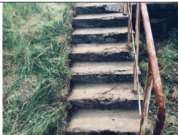
Fot. 14 – Zniszczone schody i poręcz od strony działki 199/154.
