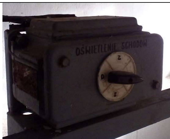
Fot. – 52 (Poziom +1.10) – rozdzielnica oświetlenia klatki schodowej.
