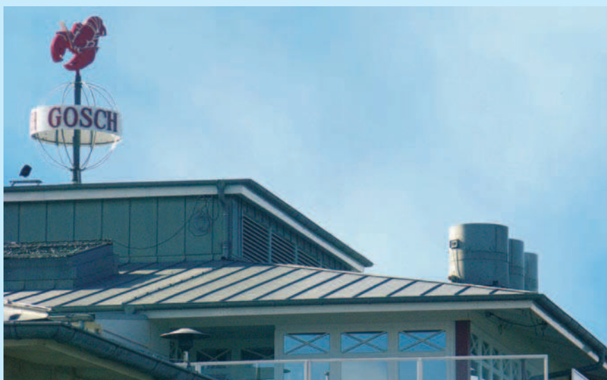
Wentylatory dachowe wielkości 630 z haubami tłumiącymi SDV ( Restauracja rybna na wyspie Sylt)
