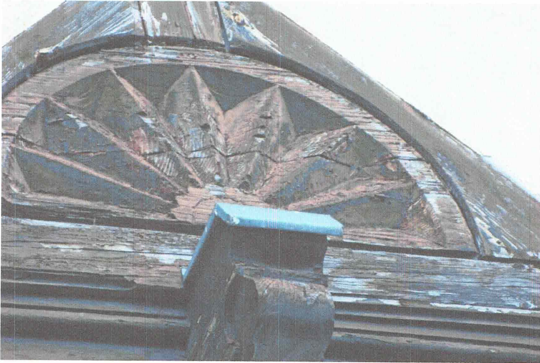
Fragment dekoracji na elewacji pd., widoczne pęknięcia, ubytki, złuszczenia farby jasne przebarwienia sinizny drewna
