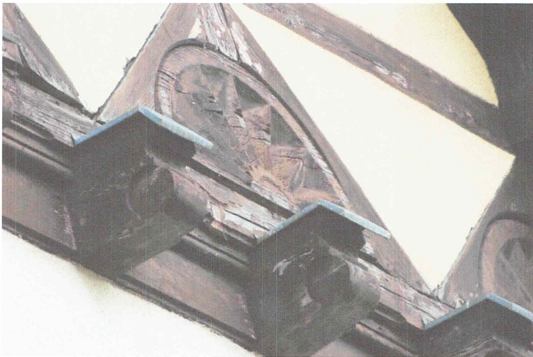
Fragment dekoracji szczytu od frontu, nad rozeta widoczne rozszczerzenie połączeń elementów
