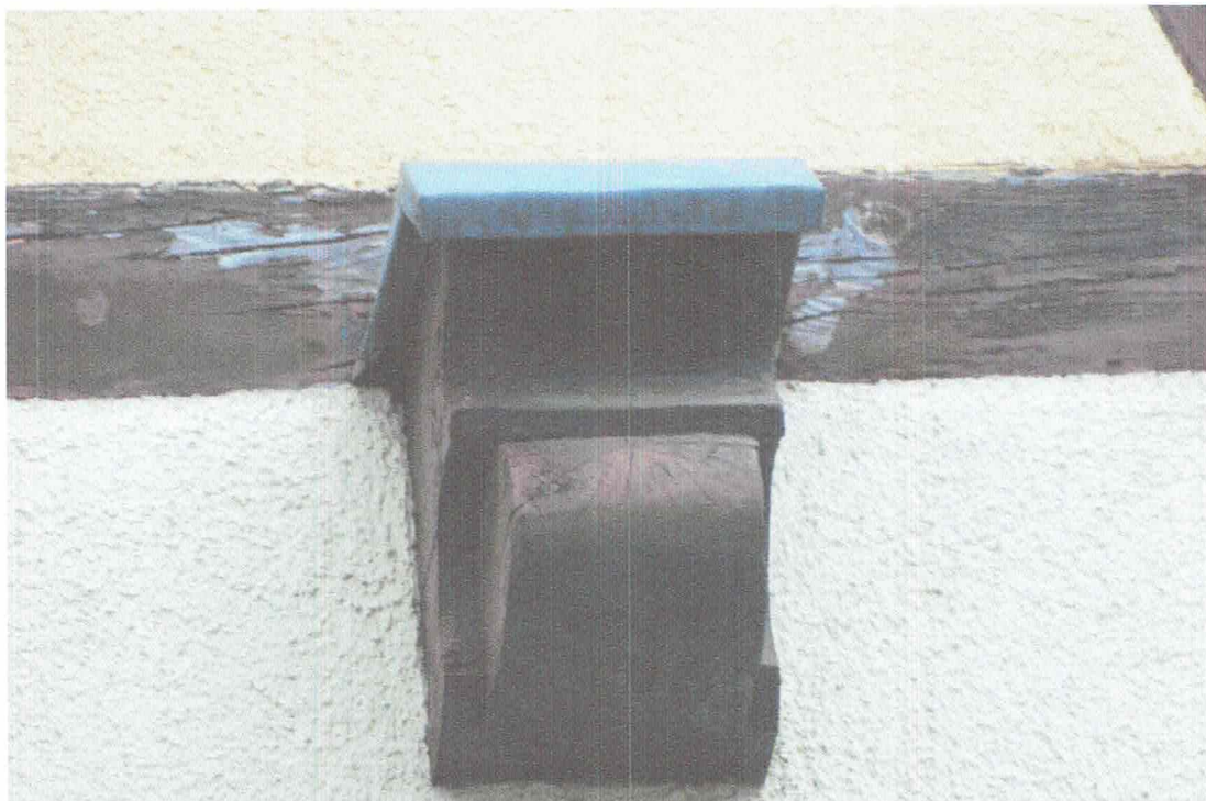
Konsolka, widoczne promieniste pęknięcia przekroju drewna, wyblakła powierzchnia ćwierć wałka, niechronionego opierzeniem.
