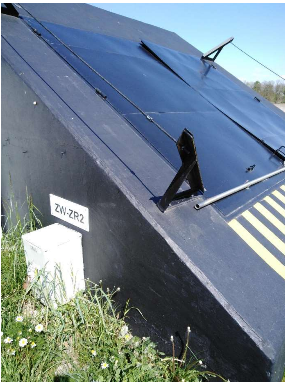
Fot. 1 – Luk do pompowni umieszczonej w zbiorniku.
