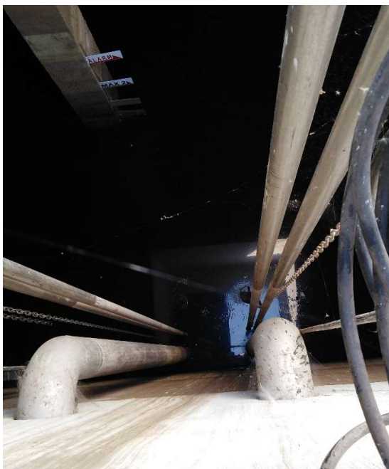
Fot. 7 – Widok na pompy zainstalowane w zbiorniku.
