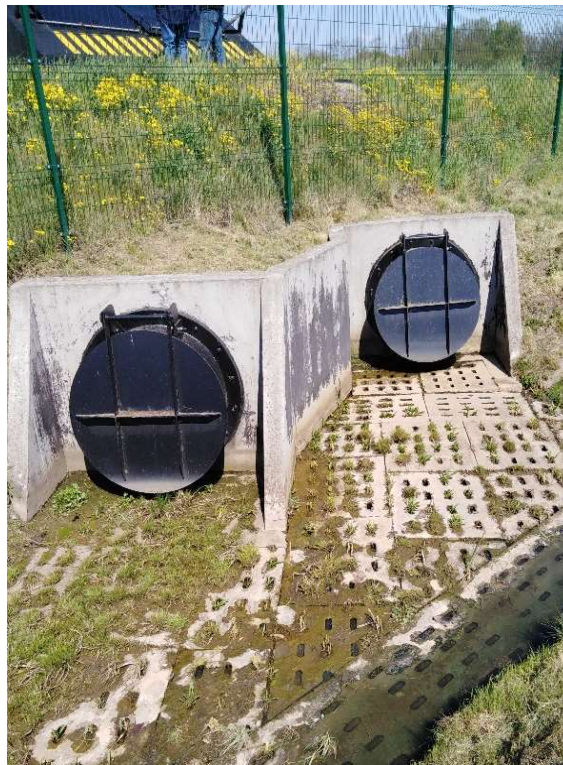
Fot. 2 – Wyloty ze zbiornika do rowu.
