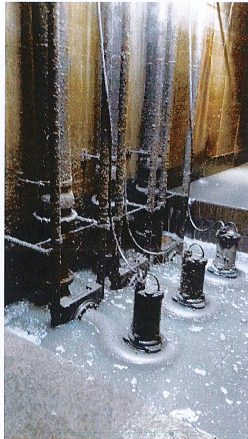
Widok na pompy z poziomu dna zbiornika
