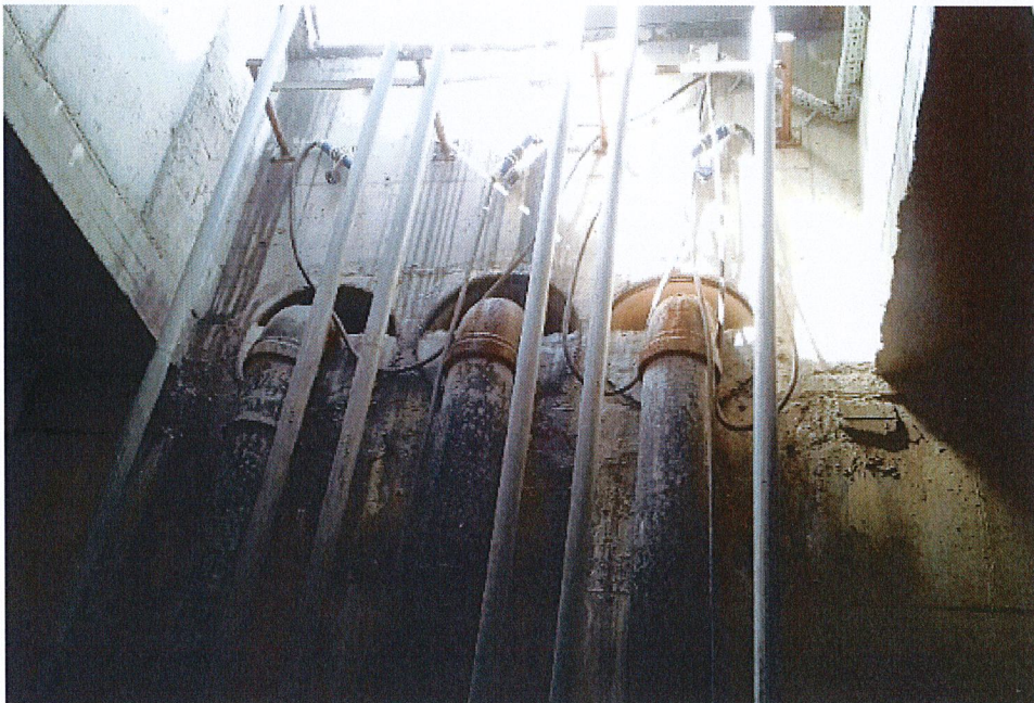
Rury tłoczne widok z dna zbiornika
