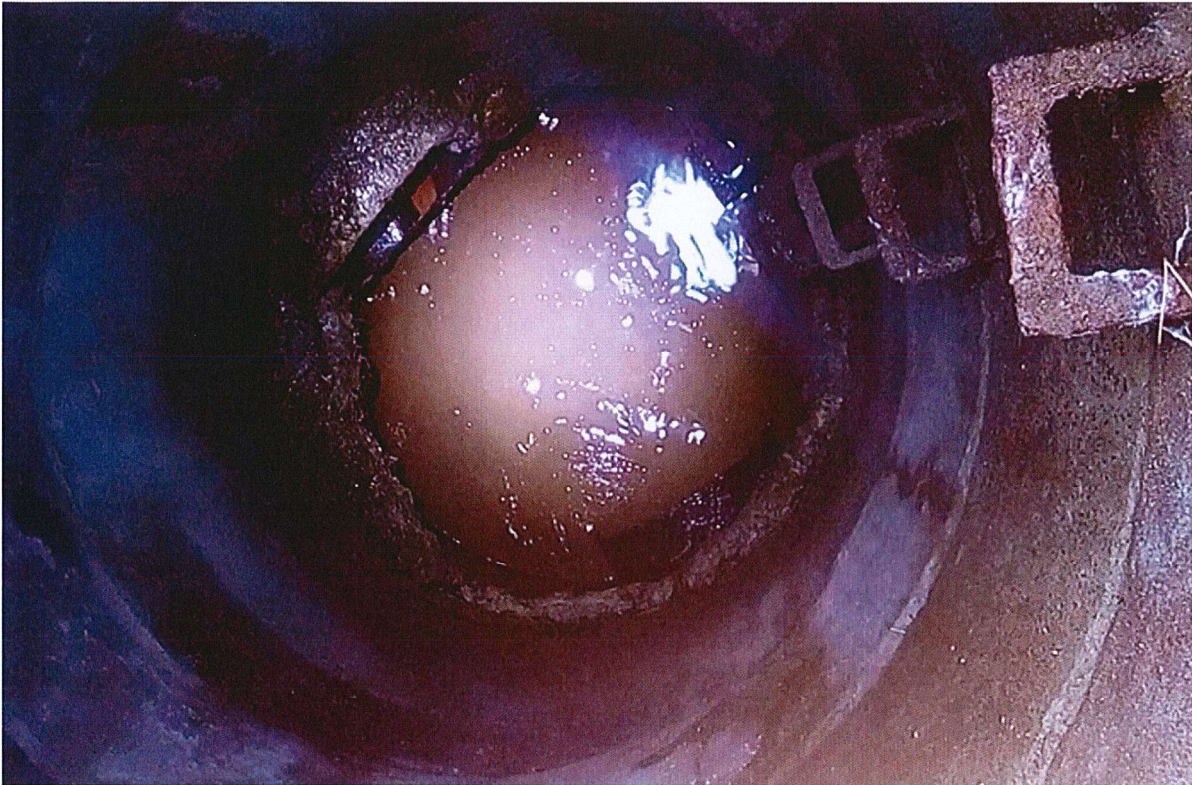
Fot.9 – Studzienka nr H.4 – do naprawy (silny napływ wód gruntowych przy dnie studzienki, w miejscu połączenia wylotu/syfonu).
