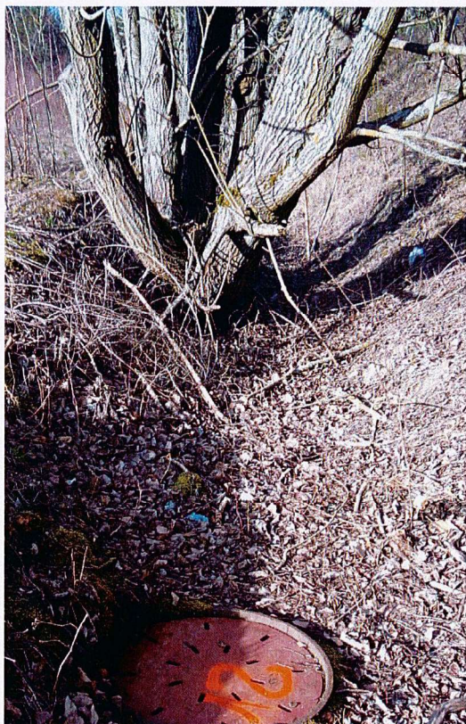
Fot.5 – Studzienka nr T.12 – do wymiany.
