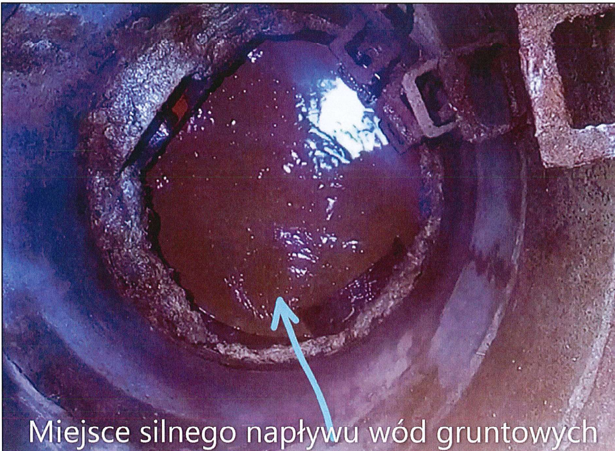
Fot.10 – Studzienka nr H.4 – do naprawy (silny napływ wód gruntowych przy dnie studzienki, w miejscu połączenia wylotu/syfonu).
