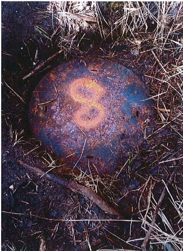
Fot.1 – Studzienka nr T.8 – do wymiany.
