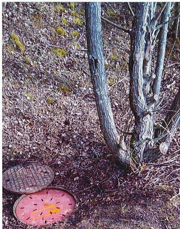
Fot.4 – Studzienka nr T.11 – do wymiany
