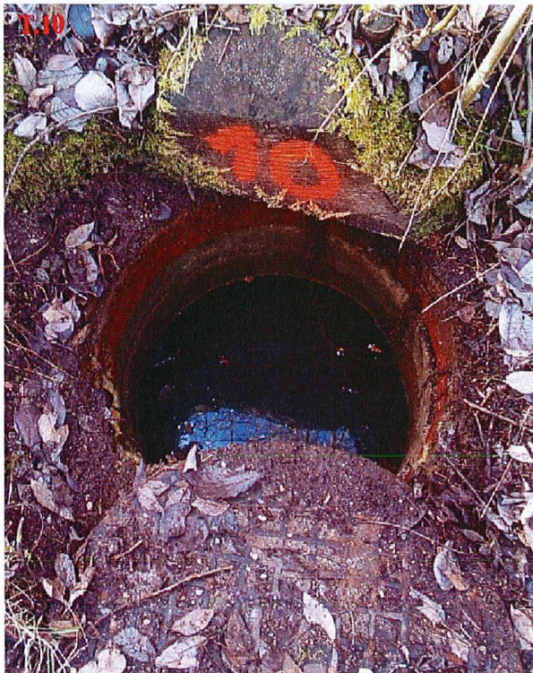
Fot.3 – Studzienka nr T.10 – do wymiany
