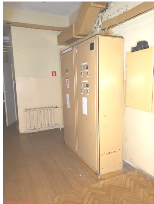
szafa sterownicza i wyłącznik główny prądu w części „A” budynku
