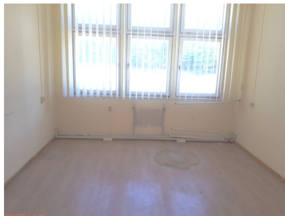
pokój – brak grzejnika, na podłodze „zniszczone” panele
