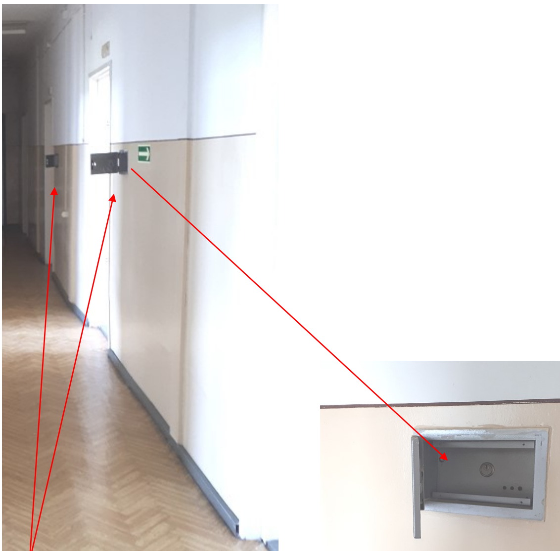
część budynku w technologii drewnianej – skrzynki, w których załączano zabezpieczenie antywłamaniowe
