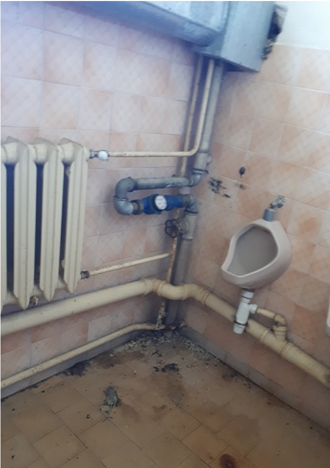
Wodomierz w drugiej cz. budynku „B”
