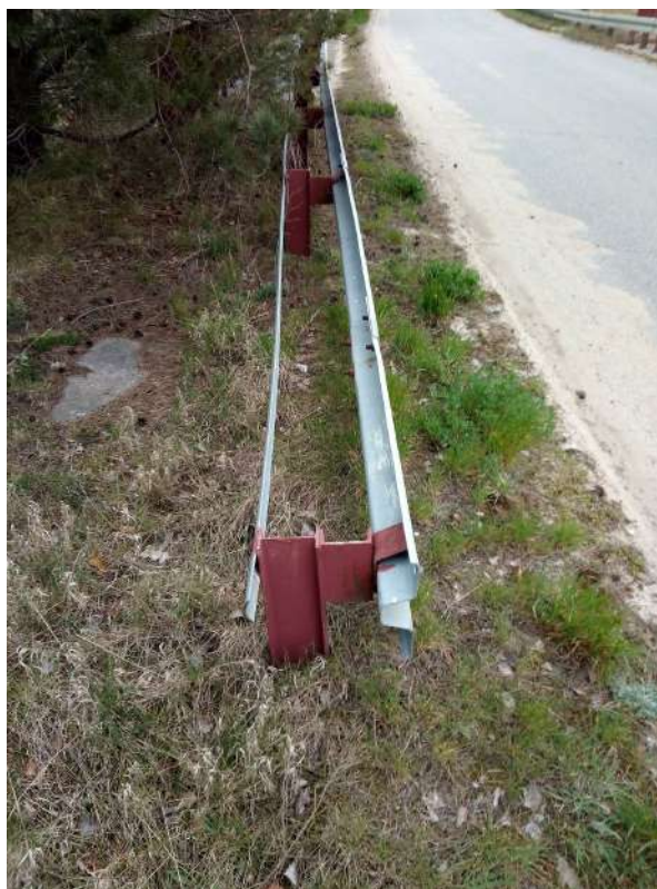
Fot. 16. Niepoprawne zakończenie bariery za obiektem WD-2 (jazda w kierunku Czymanowa).
