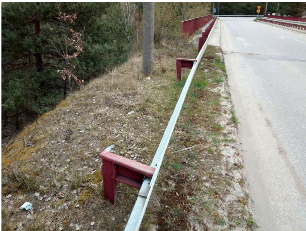
Fot. 15. Niewłaściwa strefa przejściowa za obiektem WD-1 (jazda w kierunku Czymanowa).
