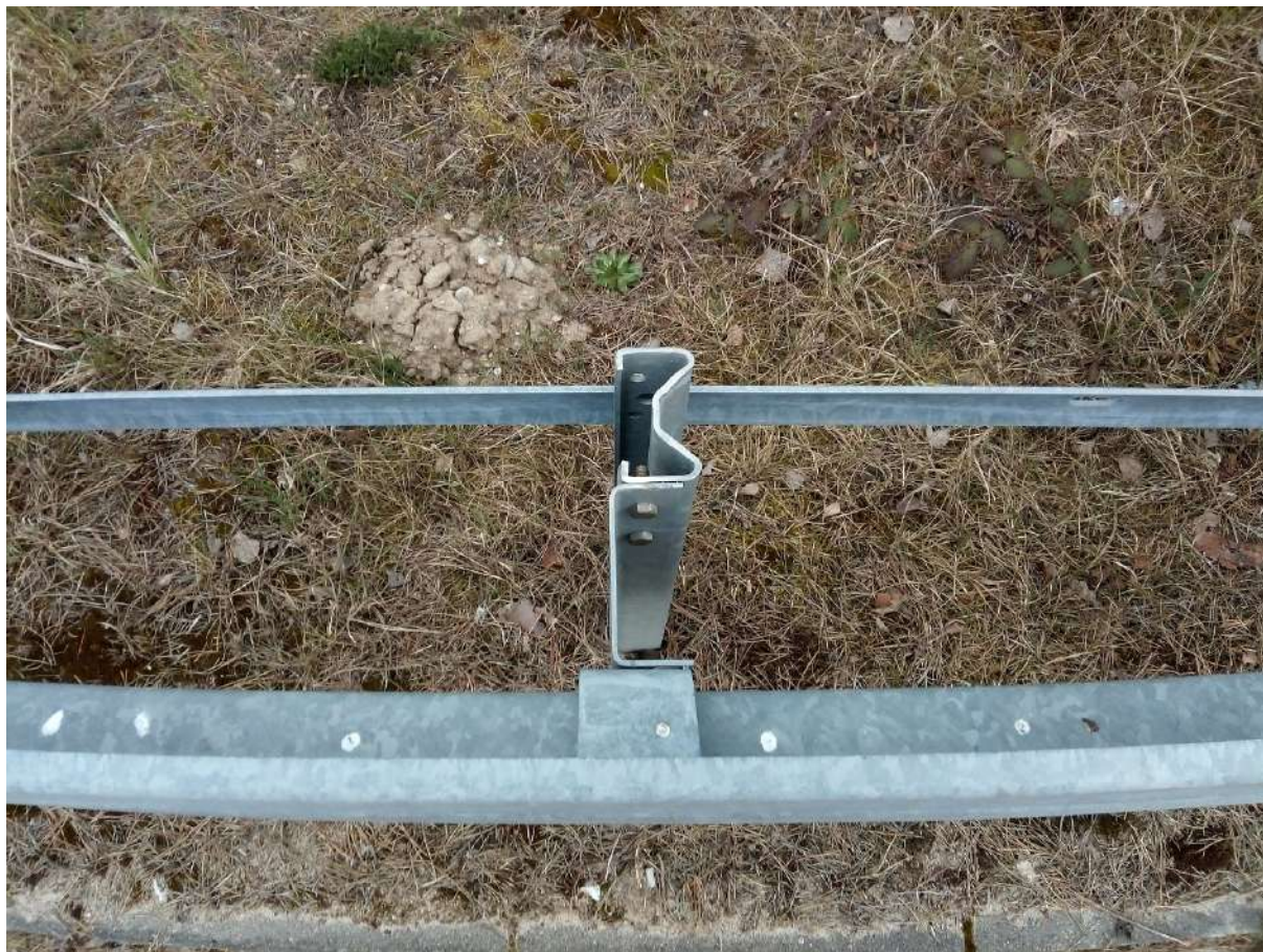
Fot. 18. Szczegół słupka bariery stalowej na wlocie skrzyżowania ulicy Okrężnej z ulicą Spokojną.
