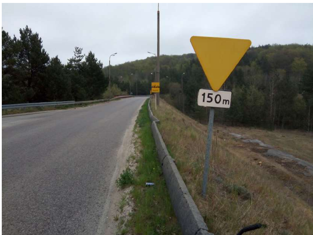
Fot. 20. Wyblakłe tarcze oznakowania pionowego, przekrzywione słupki.
