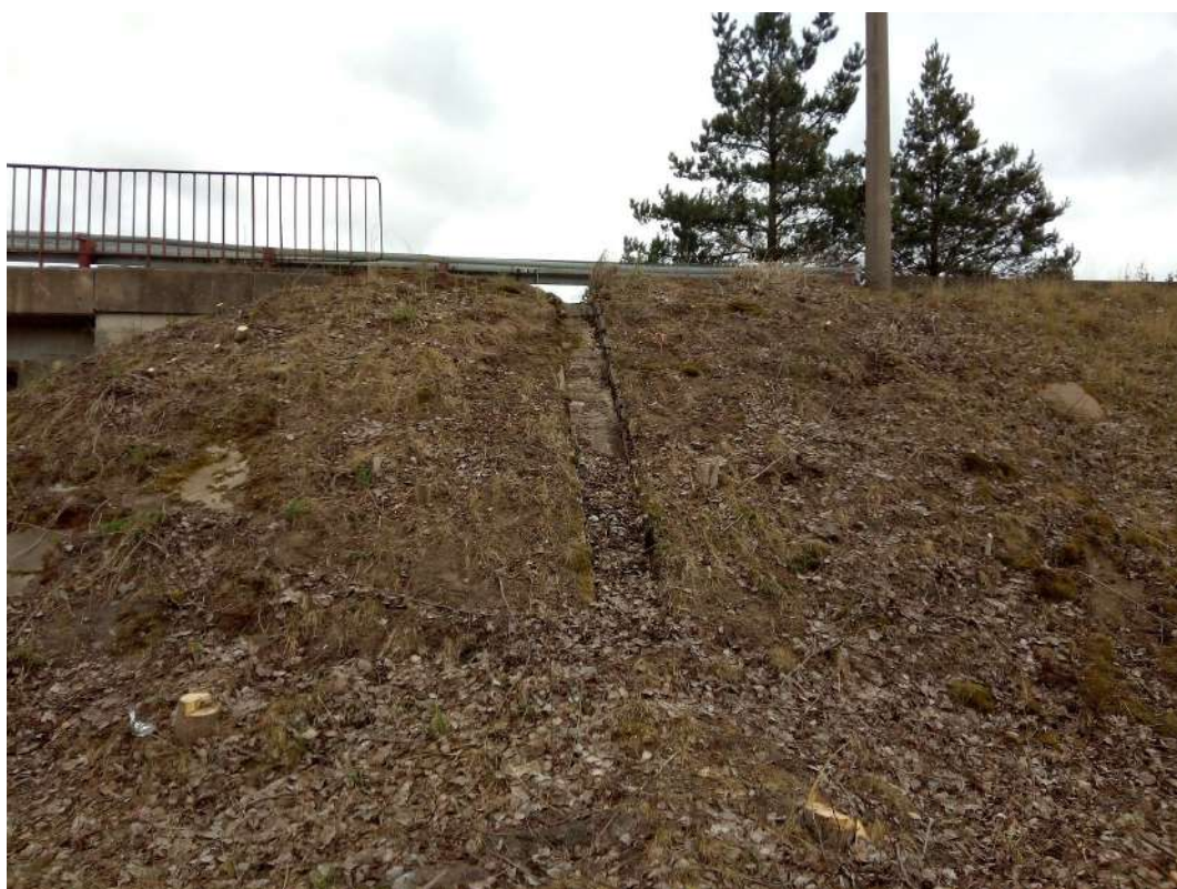
Fot. 21. Zdegradowany ściek skarpowy przy obiekcie WD-2, strona lewa od strony Kartoszyna.
