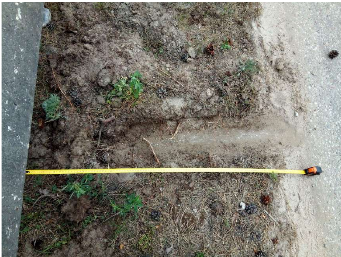
Fot. 18. Zakryta skrajna część jezdni przez nieutrzymane pobocze gruntowe.
