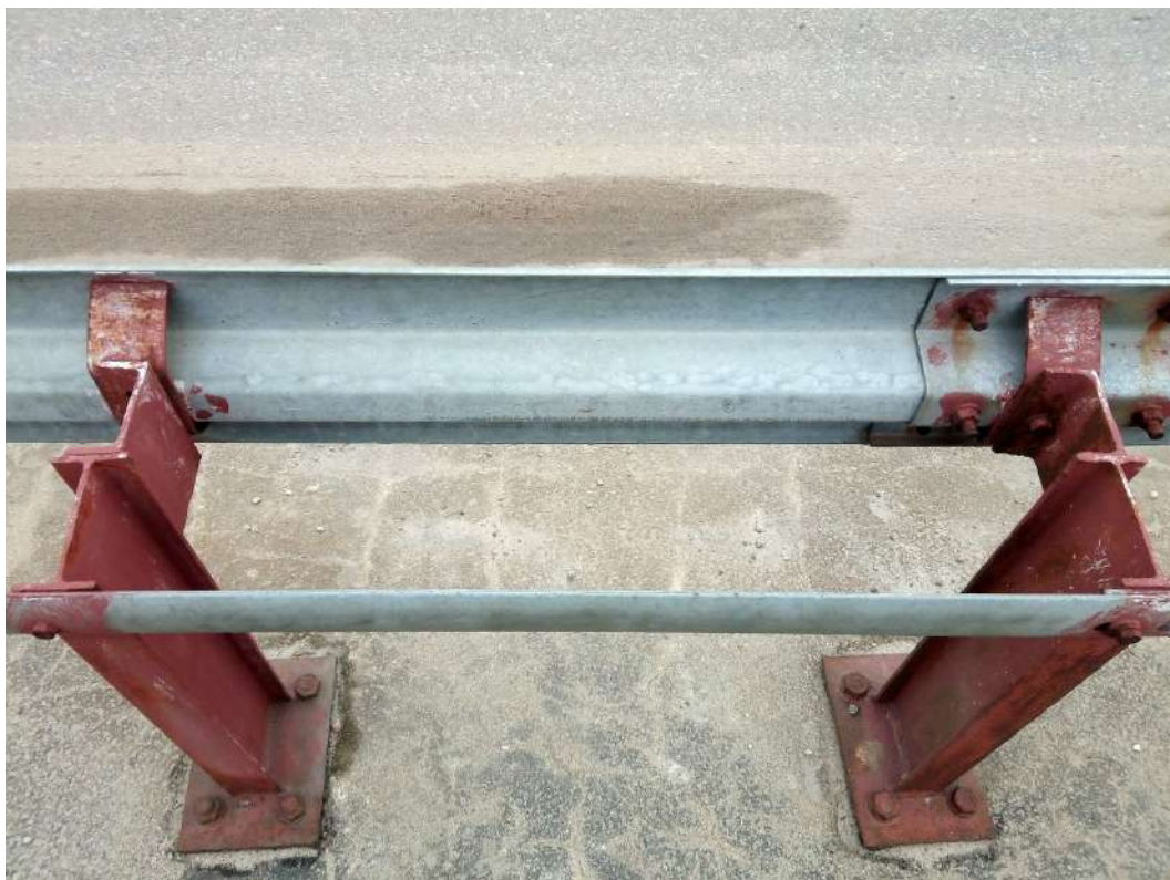
Fot. 13. Zbliżenie fragmentu bariery występujących na obiektach.
