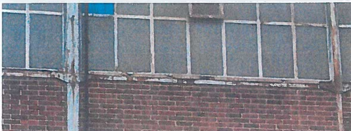
Ubytki w osadzeniu okien
