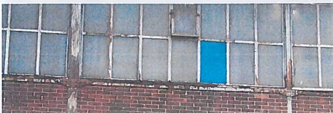
Korozja ram okiennych
