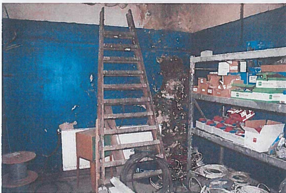
Zagrzybiona ściana od strony dobudowanych budynków
