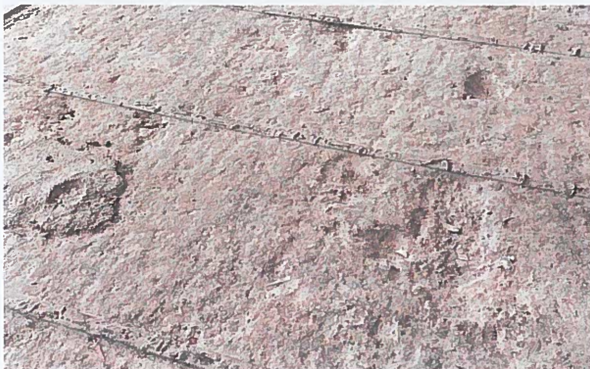
Nierówności i ubytki posadzki
