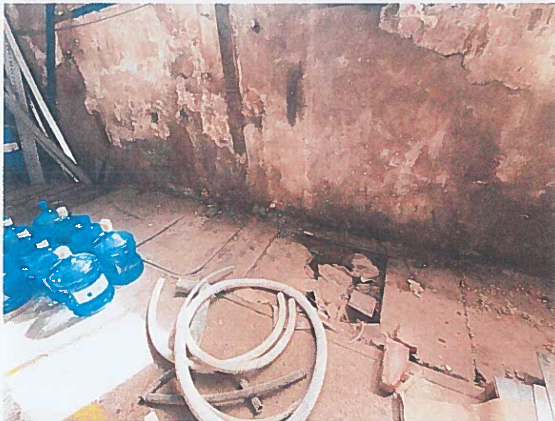
Ubytki w przekryciu kanałów posadzki
