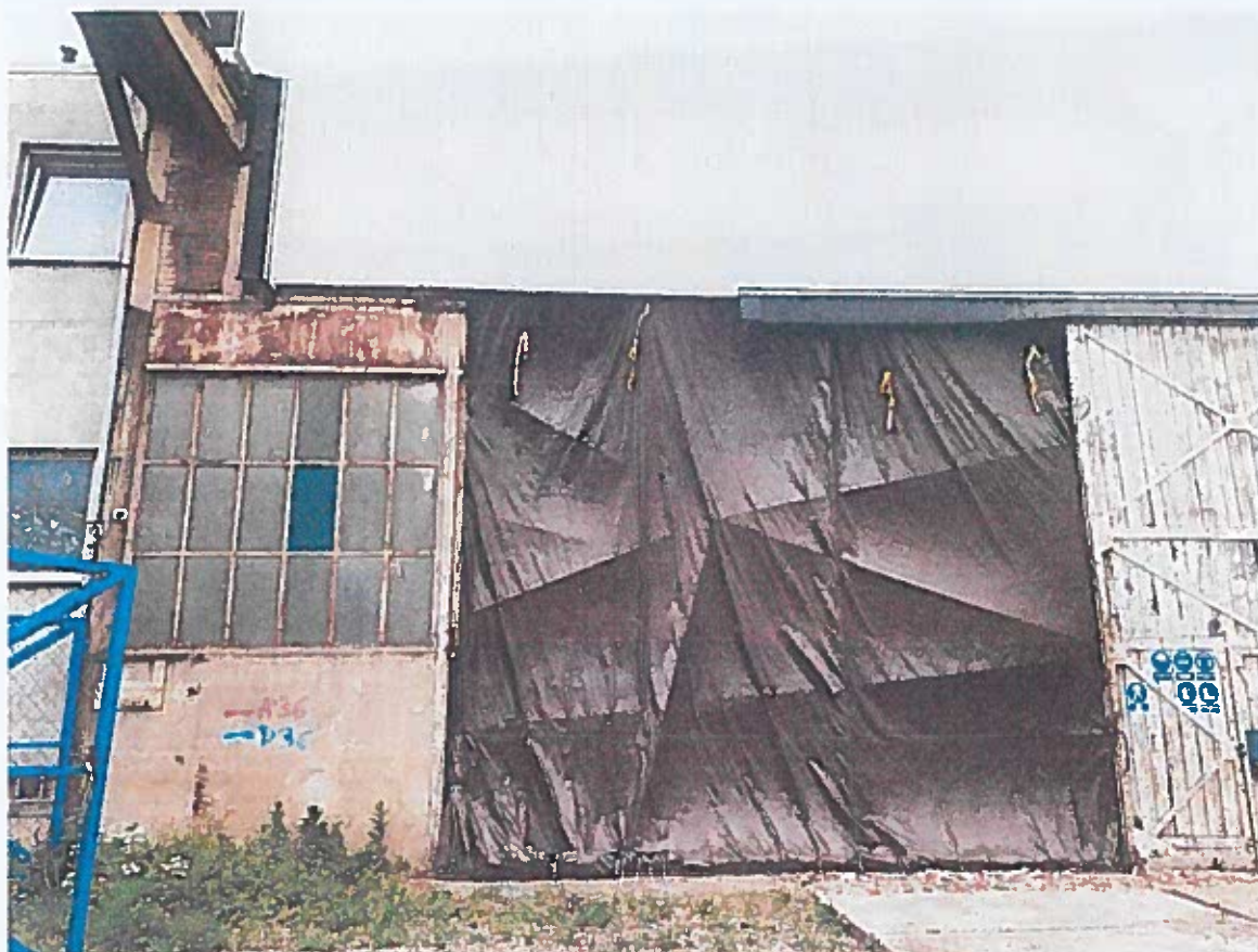
Korozja konstrukcji stalowej
