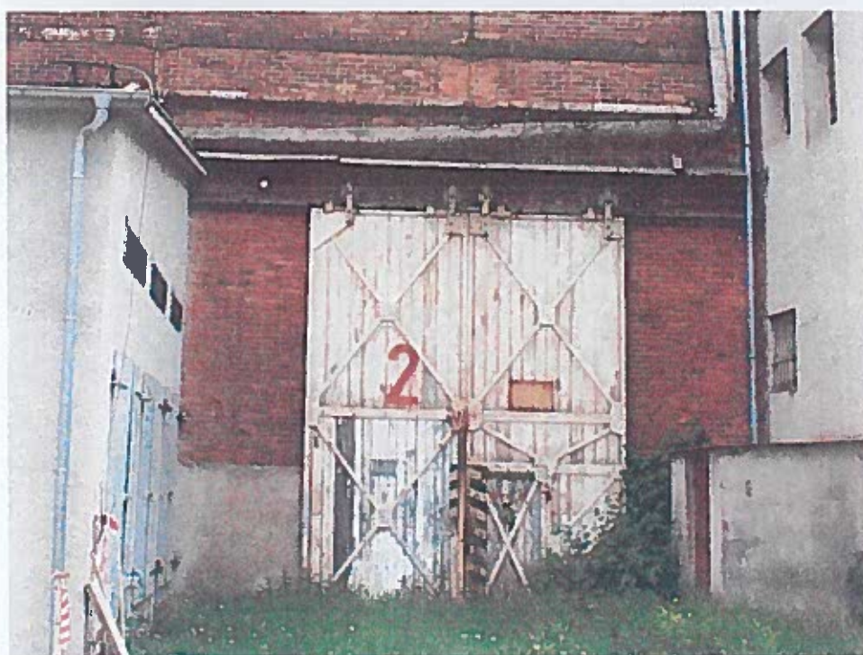
Wrota – korozja elementów stalowych, uszkodzenia wypełnienia z drewna
