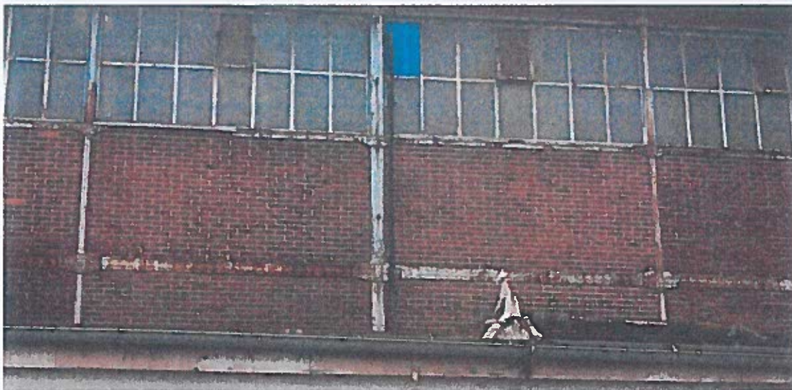
Korozja stalowej konstrukcji
