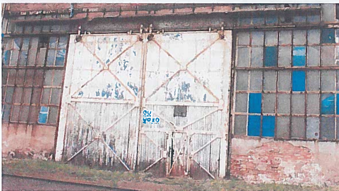
Uszkodzenia wrót drewnianych ściany południowej
