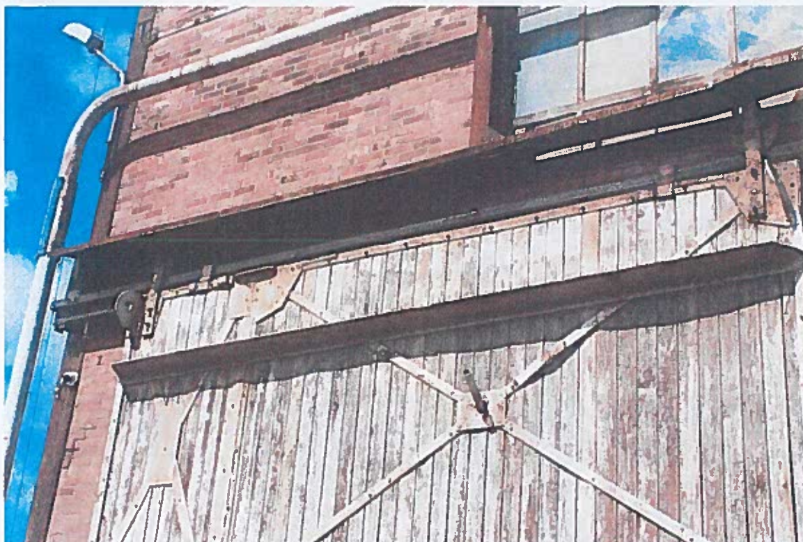
Skorodowana konstrukcja ściany, prowadnice i zadaszenie wrót oraz konstrukcja stalowa wrót
