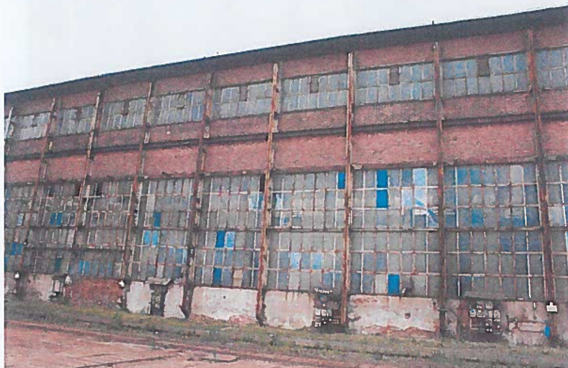
Korozja konstrukcji stalowej
