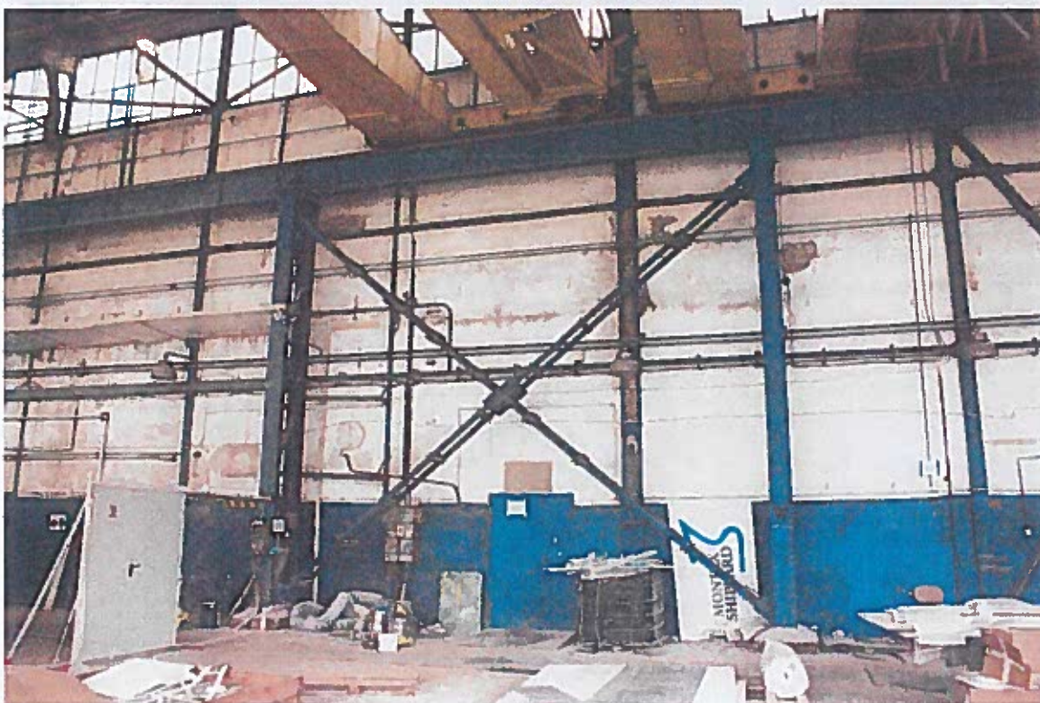
Uszkodzenia i zabrudzenia tynków wewnętrznych
