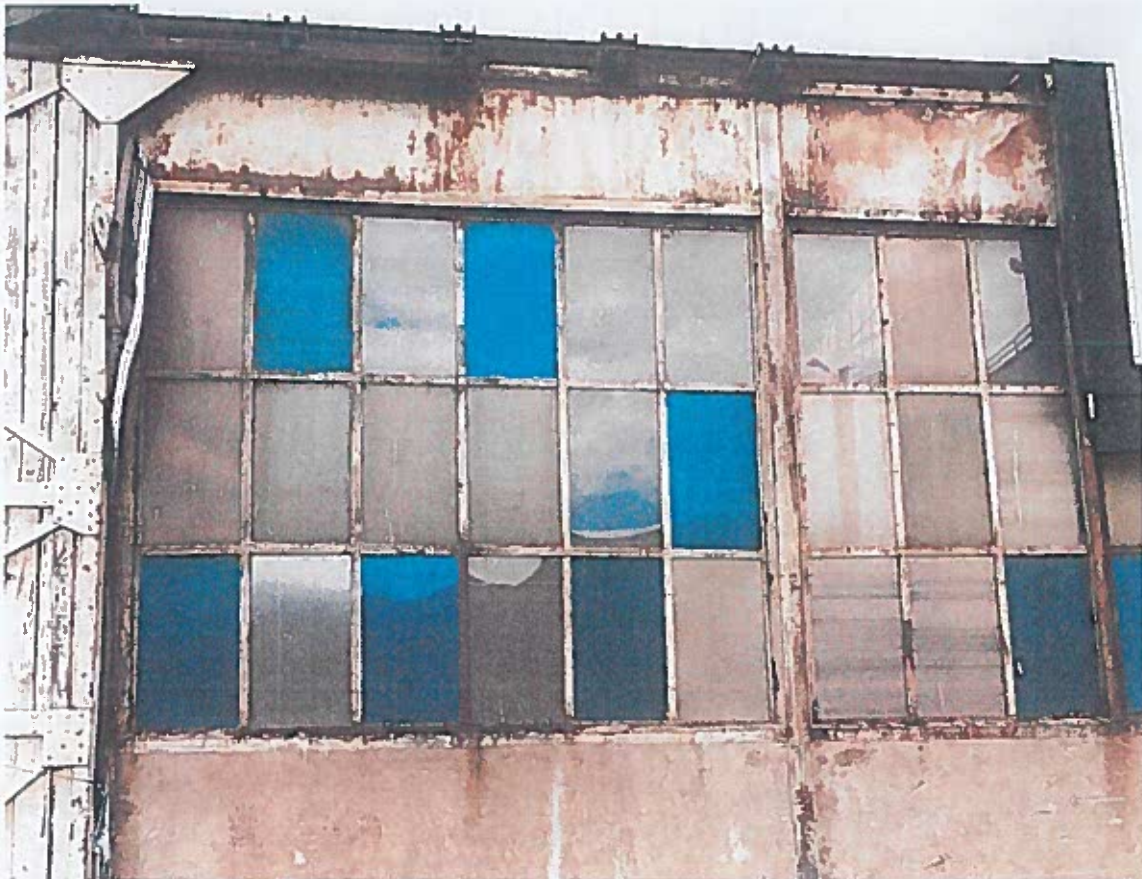
Korozja konstrukcji, okien, szklenie do wymiany
