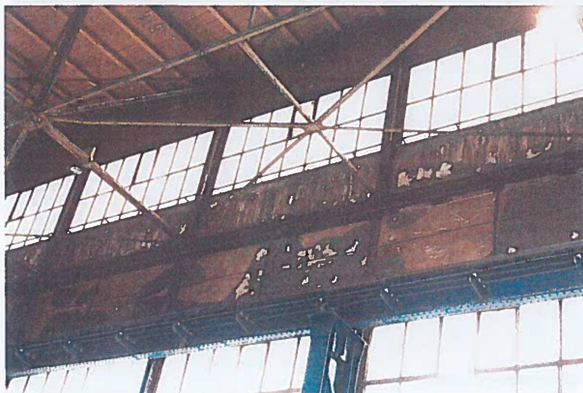
Uszkodzenia i zabrudzenia tynków wewnętrznych
