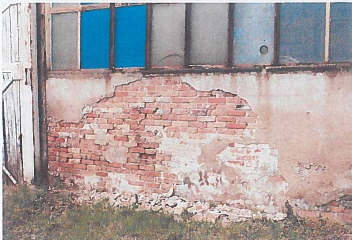
Brak zaprawy w spoinach cegieł, brak tynku, odpadający tynk
