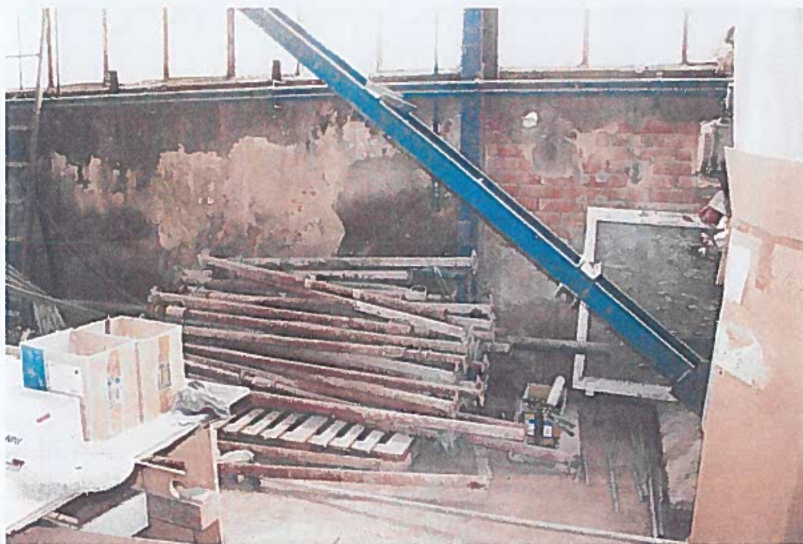
Uszkodzenia ścian cokołu oraz ubytki tynków wewnątrz
