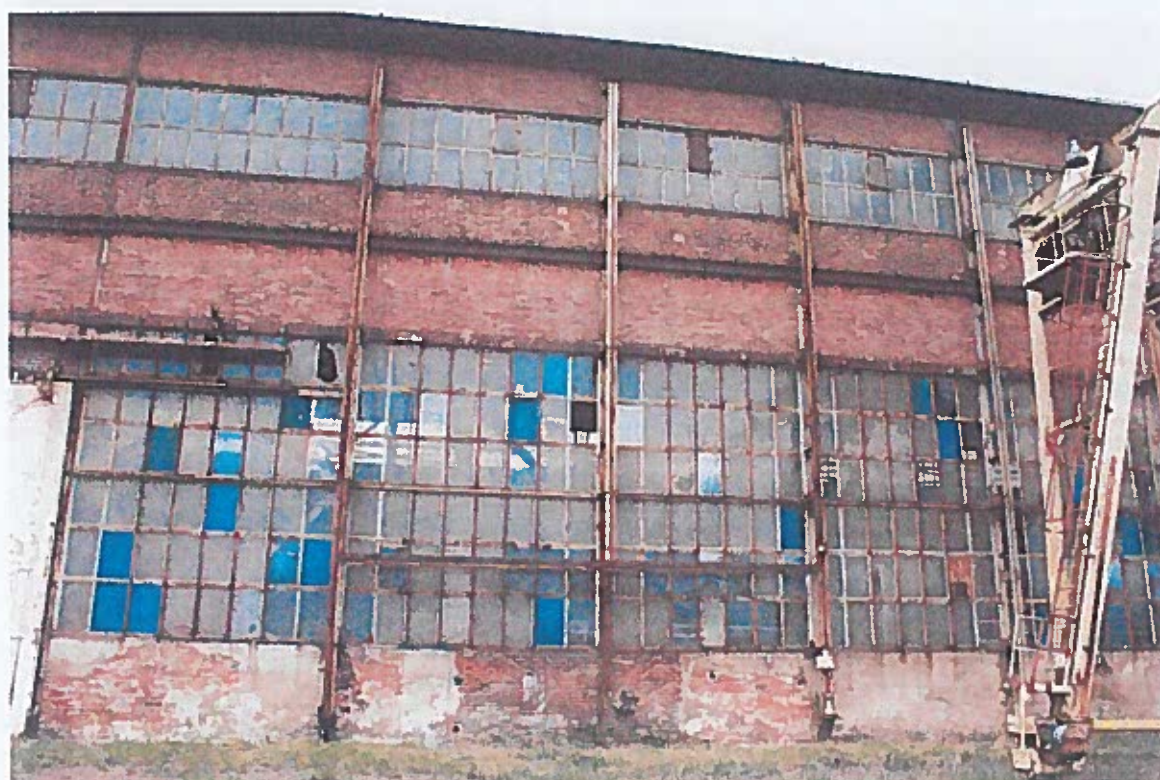
Uszkodzenia cokolu, ubytki szklenia
