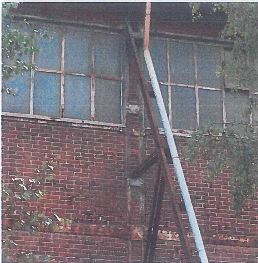
Korozja stalowej konstrukcji
