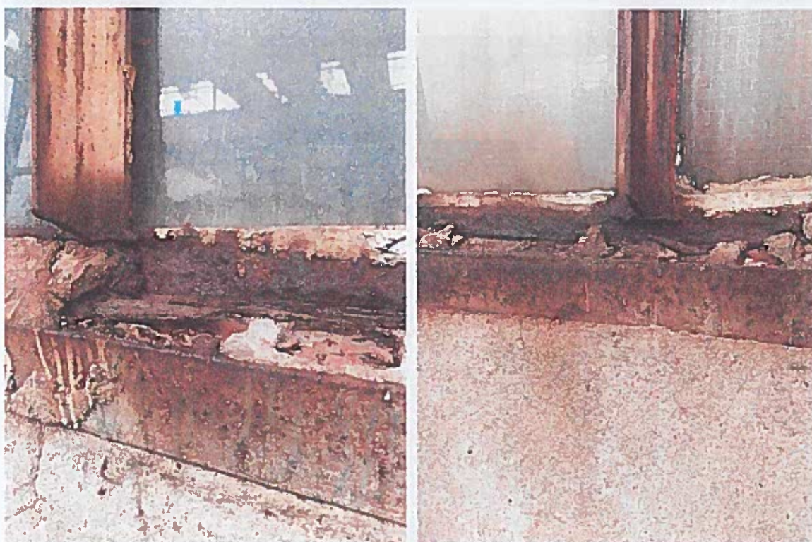
Korozja ram stalowych okien
