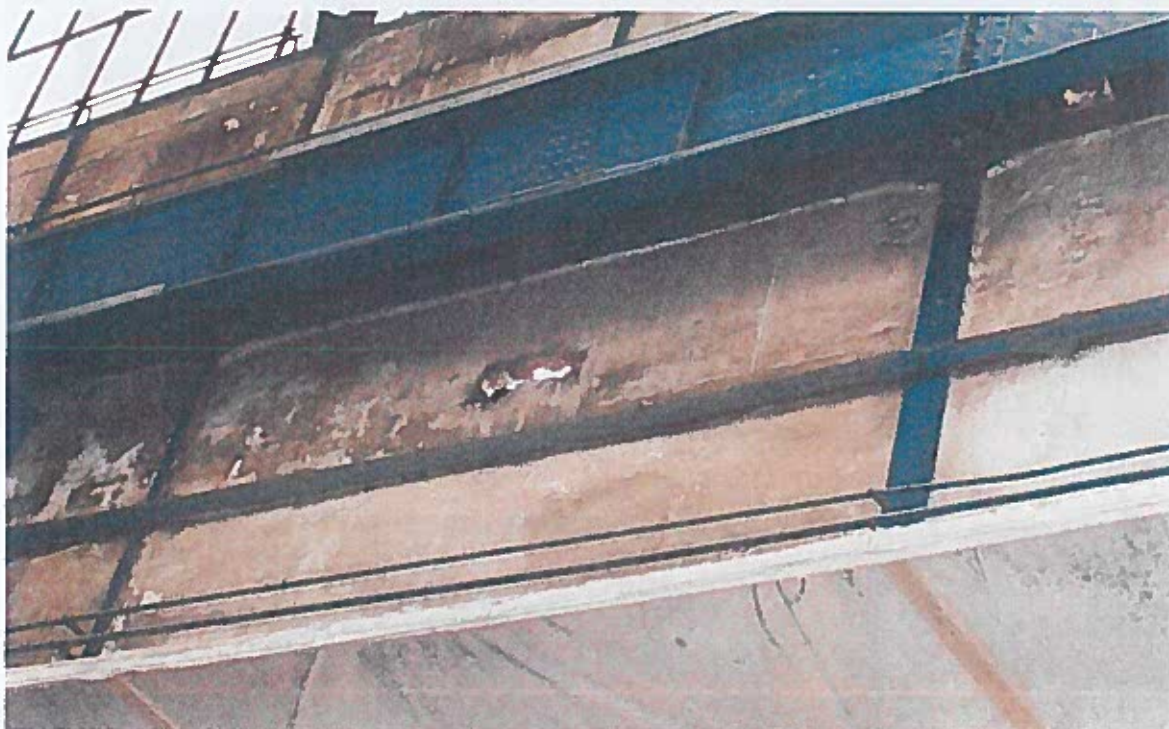
Ubytki/otwory w murze
