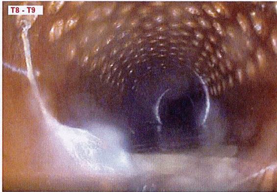
Foto. 43 Odcinek T.8-T.9 - intensywny dopływ wód przez uszkodzony rurociąg
