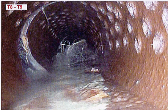
Foto. 45 Odcinek T.8-T.9 - uszkodzone łączenia rur, zanieczyszczenie korzeniami
