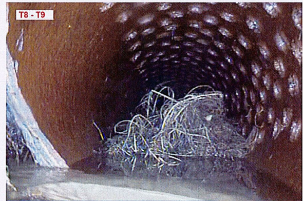
Foto. 46 Odcinek T.8-T.9 - uszkodzone rury drenażowe, korzenie
