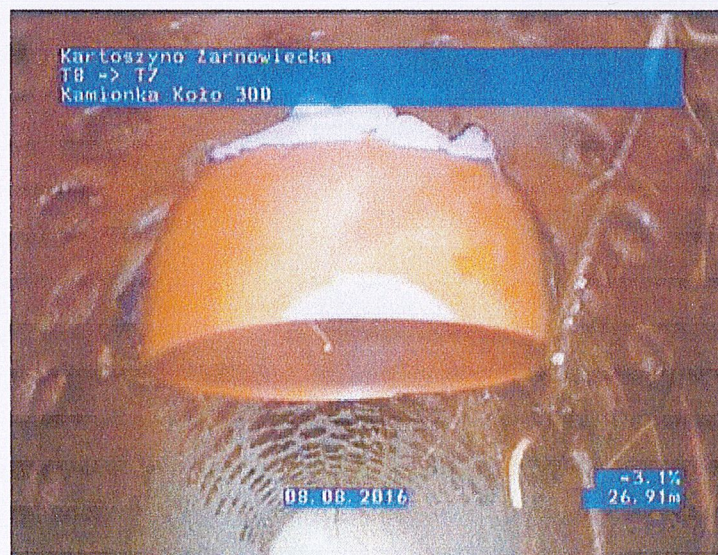
Foto. 47 Odcinek T.8-T.9 - przyłącze otwarte z oczka wodnego na terenie Pipelife Polska S.A.
