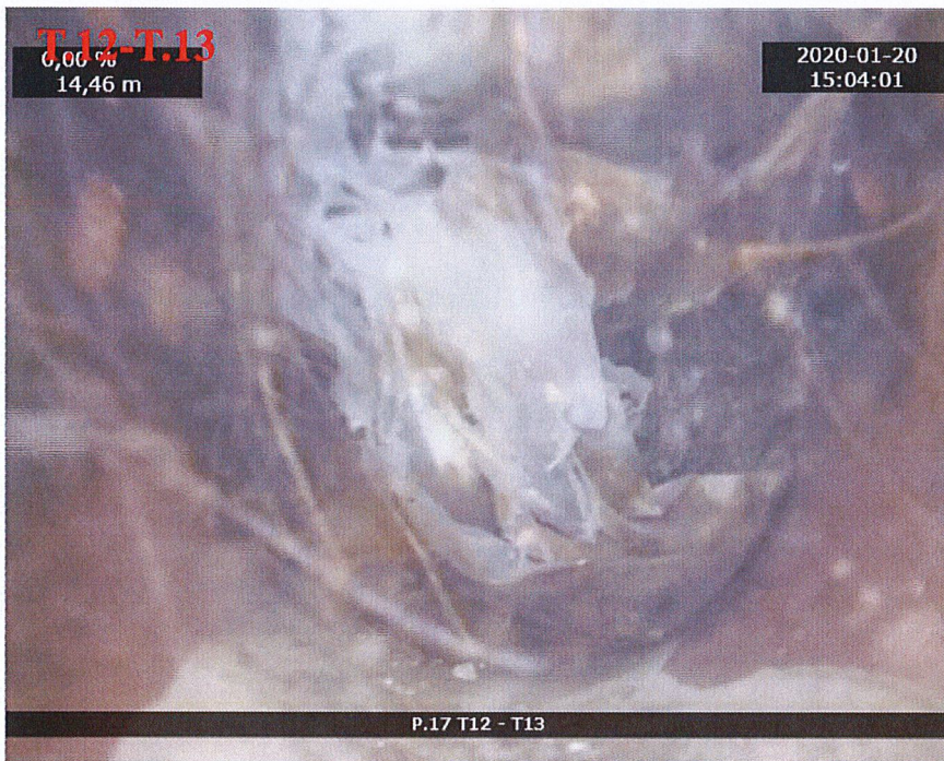
Foto. 49 Odcinek T.12-T.13 - zapadnięcie rur (14,5 m od T.12)
