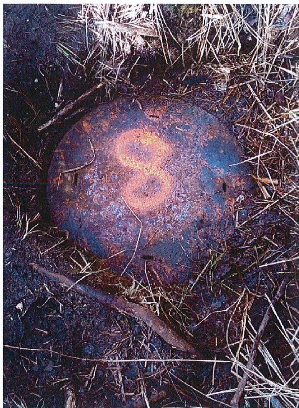
Fot.1 – Studzienka nr T.8 – do wymiany.
