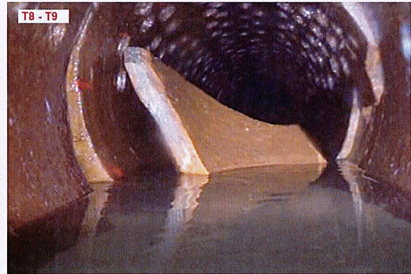
Foto. 44 Odcinek T.8-T.9 - uszkodzone rury drenażowe, liczne spękania i odlamki
