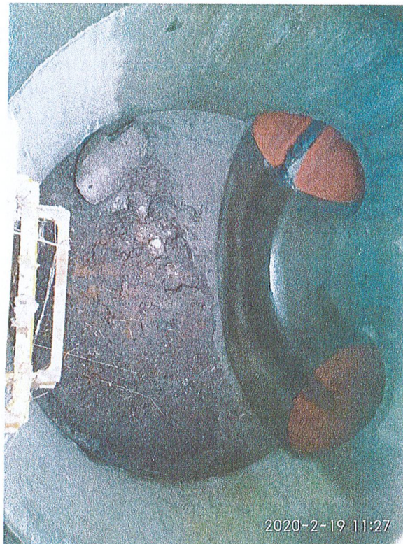
Fot. nr 5 Studnia kanalizacji deszczowej Kd4. Liczne zabrudzenia kinety.
