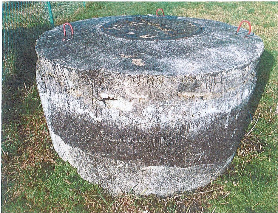
Fot. nr 1 Studnia kanalizacji opadowej Kw1. Liczne ubytki w korpusie studni
