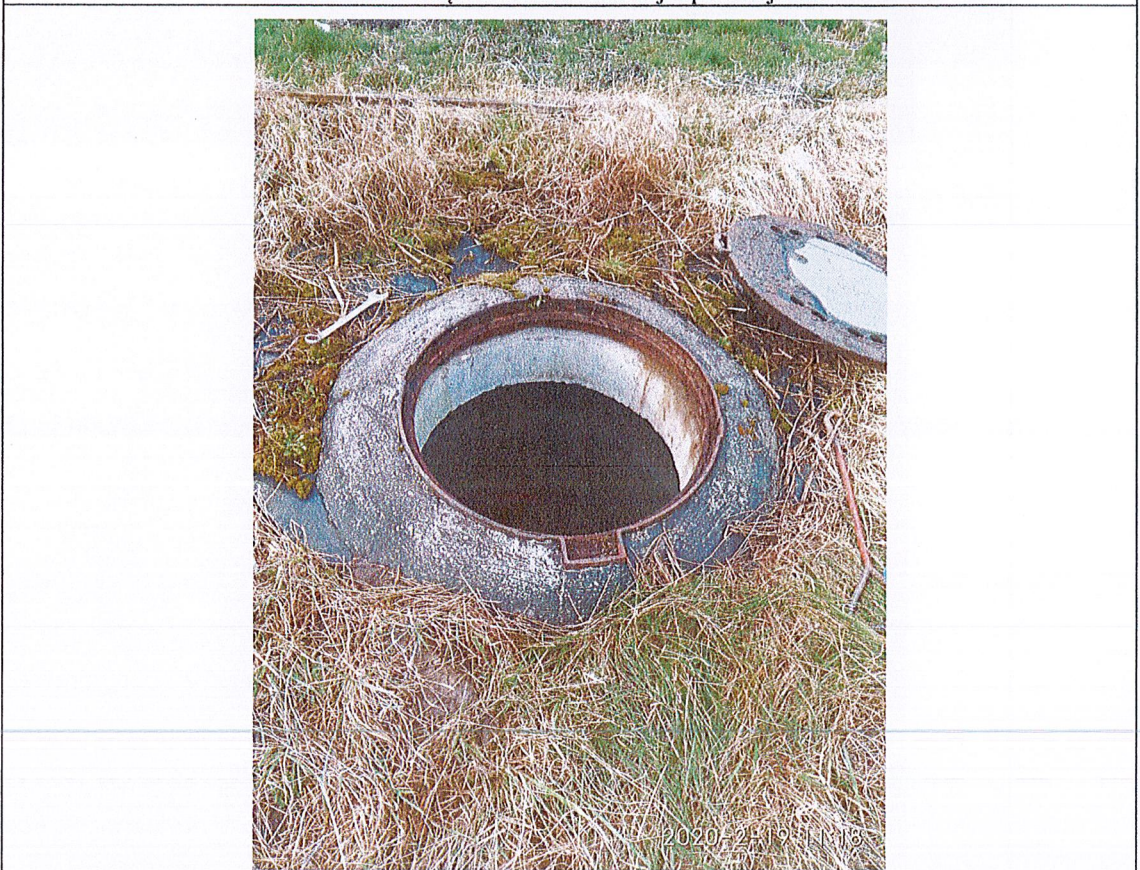
Fot. nr 4 Studnia kanalizacji deszczowej Kd3. Pokrywa zakryta ziemią i liczną roślinnością
