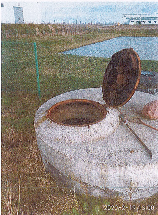
Fot. Nr 8 Studnia kanalizacji deszczowej Kd6. W tle widoczna studnia kanalizacji opadowej Kw1 z wylotem do zbiornika. Studnie i właz zabezpieczyć powłokami odpornymi na działanie czynników atmosferycznych
