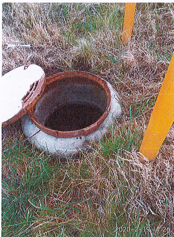
Fot. nr 7 Studnia kanalizacji deszczowej Kd4. Pokrywa do odkopania i zabezpieczenia wraz z włazem.
