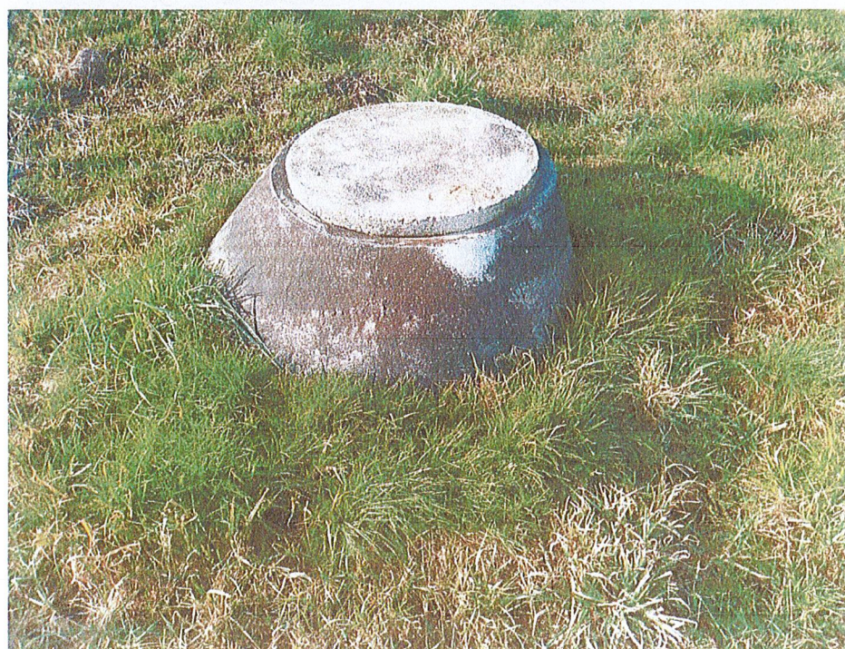
Fot. nr 2 Właz betonowy kanalizacji opadowej Kw4. Uzupełnić o uchwyt.
